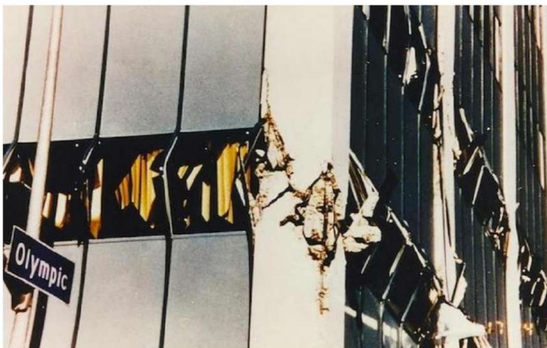
IMAGEM 2 – Patologia em Pilar Devido a Ocorrência de Flambagem
