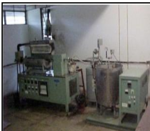
Figura 4.2. Forno elétrico rotativo marca CHINO acoplado à caldeira elétrica
