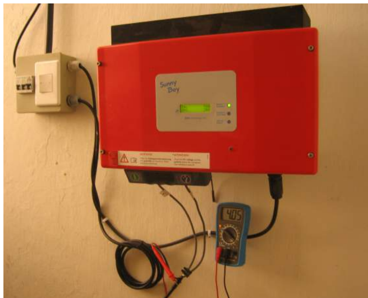
Figura 66. Inversor DC-AC SunnyBoy 1100 instalado na estação climatológica do CEAR. Fonte: Autoria própria.
