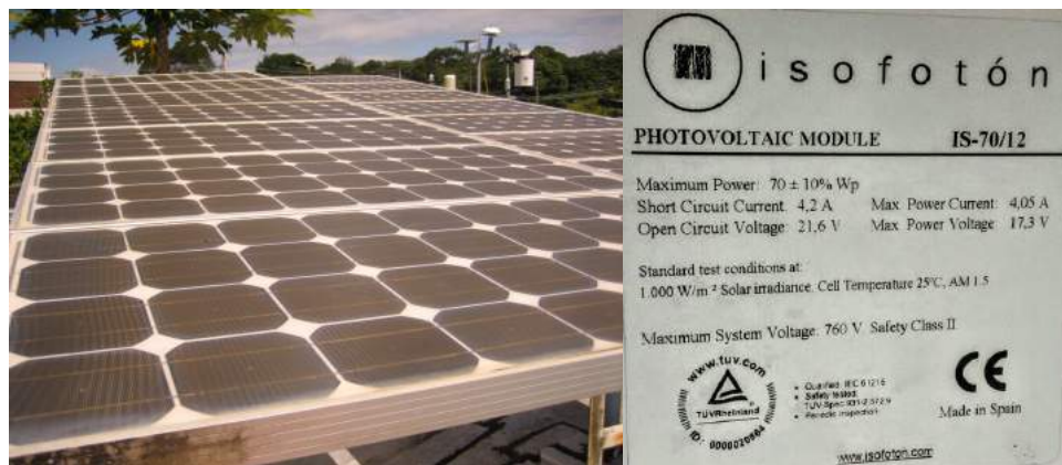
Figura 65. Módulos Isofotón instalados na estação climatológica do CEAR. Fonte: Autoria própria.
