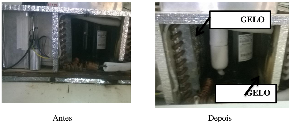
Figura 3.8 - Formação de gelo na superfície do compressor e evaporador encontrados por Leite (2015).
