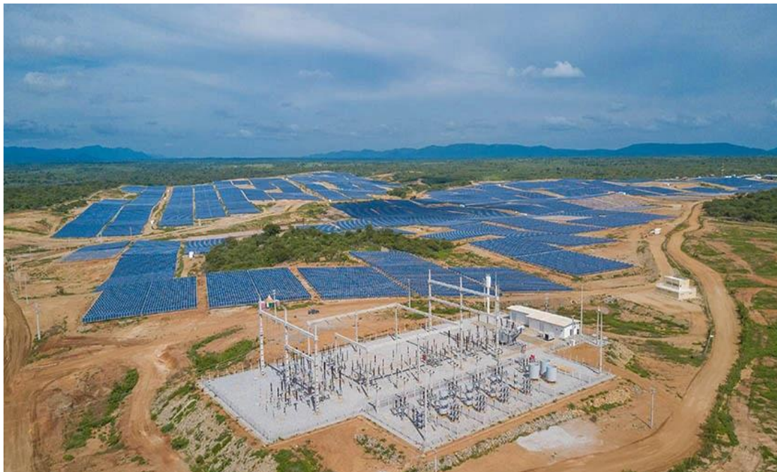
Figura 6: Complexo Solar de Coremas localizada no Estado da Paraíba, Brasil.
