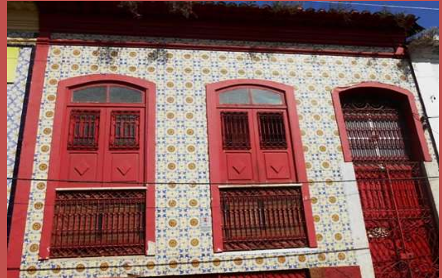
Fig.61 – Revestimento de fachada do tipo tapete no Centro Histórico de São Luís/Ma
