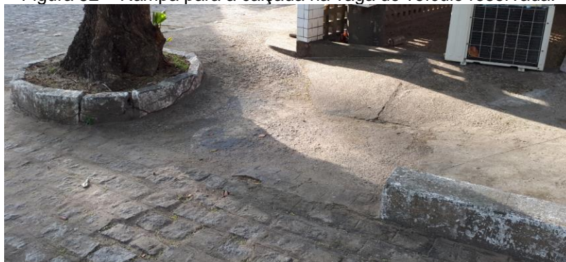
Figura 52 – Rampa para a calçada na vaga de veículo reservada.
