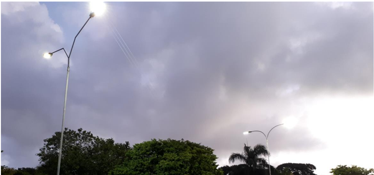
Figura 30 – Luminárias em Led.
