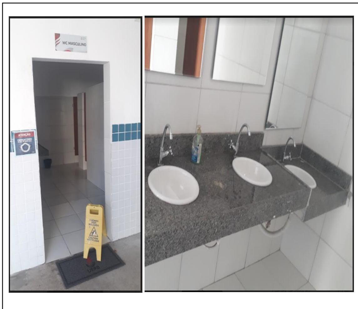
Figura 26: Banheiro com acessibilidade sem sinalização.
