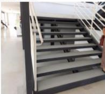
Figura 5 - Escada central, com espelhos vazados e corrimão incorreto.
