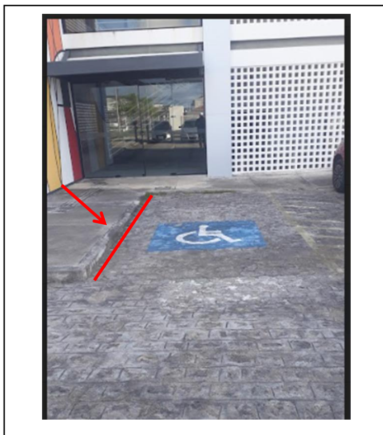
Figura 28: Vaga de estacionamento inacessível.
