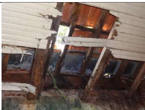
Uma das salas encontra-se com o teto quebrado.
