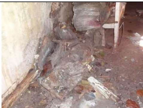
Situação dos documentos que se encontra na sala do teto quebrado
