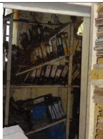
Estante localizada próxima ao teto quebrado, documentos totalmente destruídos.
