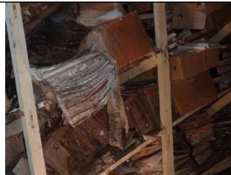
Estado dos documentos em uma das salas que está com o teto quebrado
