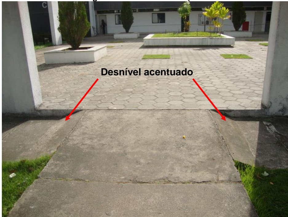
Figura 19 – Desnível em calçada.
