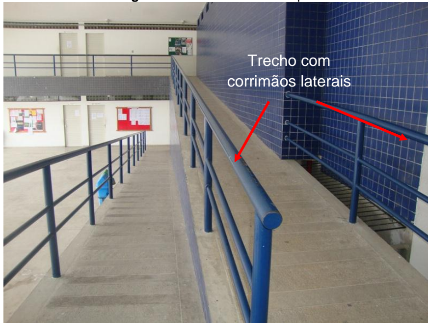
Figura 14 – Corrimãos da rampa.
