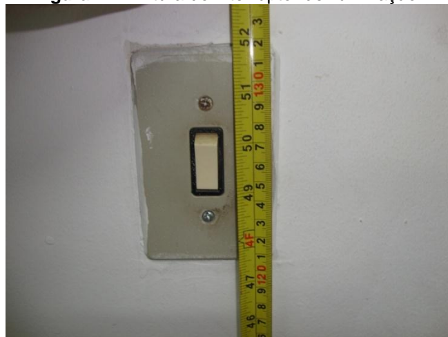
Figura 21 – Altura do interruptor de iluminação.
