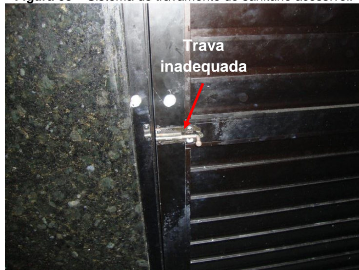
Figura 05 – Sistema de travamento do sanitário acessível.
