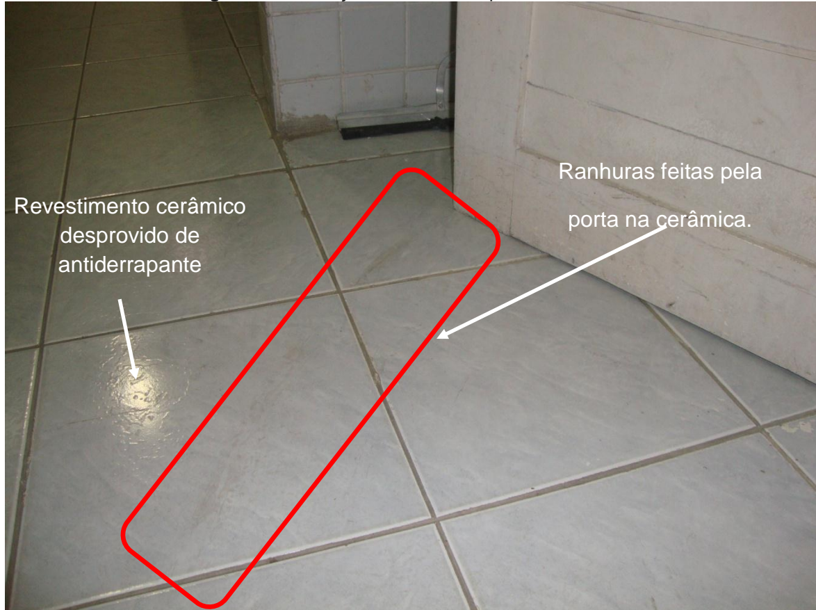
Figura 04 – Esforço na abertura da porta do banheiro.
