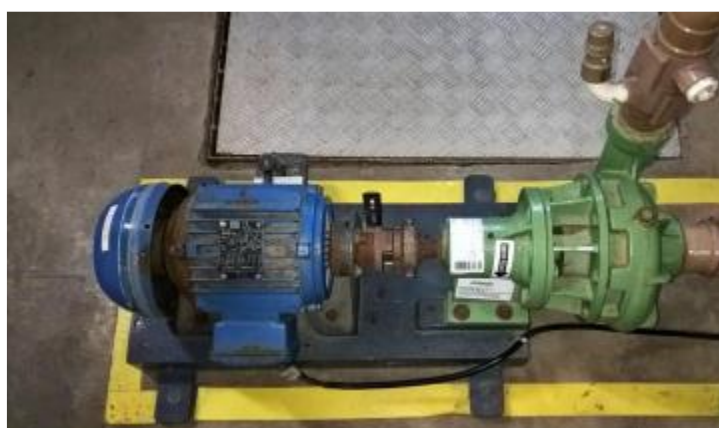
Figura 4.2 - Conjunto motor-bomba (Flores, 2021).
