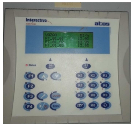
Figura 3.14 – IHM do CLP parte frontal do Painel.
