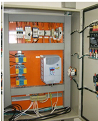
Figura 3.8 – Foto do painel com inversor de frequência.
