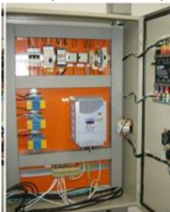
Figura 13 - Foto do painel com inversor de frequência.
