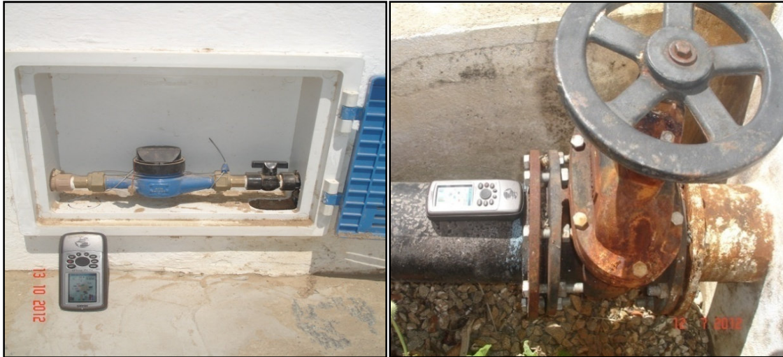
Figura 4.15 – Levantamento da cota topográfica na saída do reservatório e em um cavalete residencial
