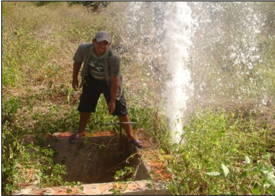
Figura 5.28 – Manobra de descarga na rede de distribuição de água
