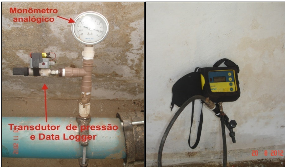
Figura 4.14 – Equipamentos de medição instalados na rede e em uma residência
