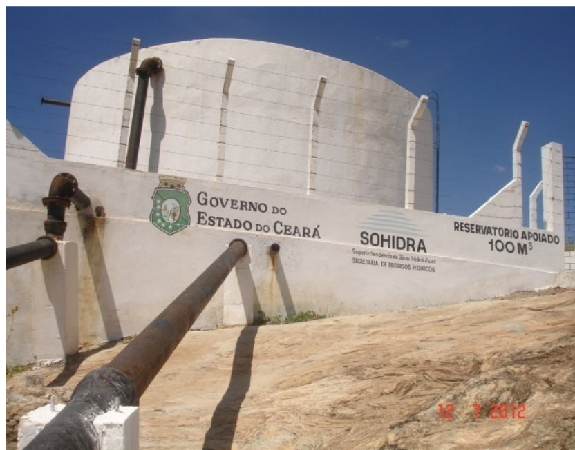
Figura 4.4 – Reservatório de distribuição
