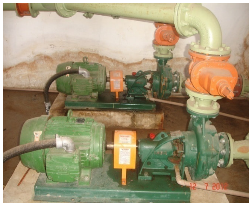
Figura 4.5 – Estação de bombeamento
