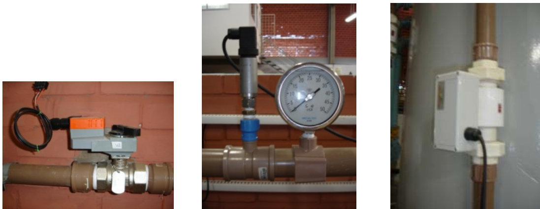
Figura 4. 5 - Válvula redutora, medidores de pressão e medidor de vazão.
