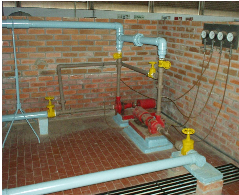
Figura 28 - Instalação e bombas utilizadas na experiência
