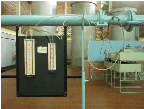
Figura 8 - Foto do tubo Venturi instalado
