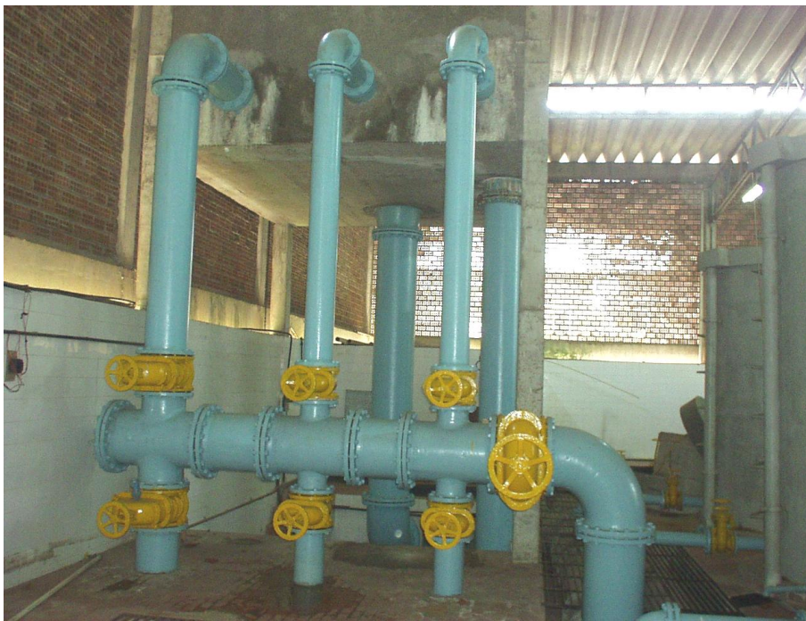
Figura 39 - Saída do reservatório elevado
