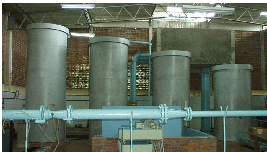
Figura 36 - Reservatórios apoiados cilíndricos
