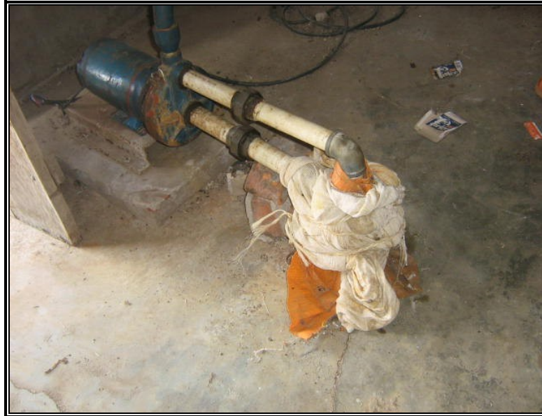
Figura 16: Poços tubulares Foto: Franklin Mendonça Linhares
