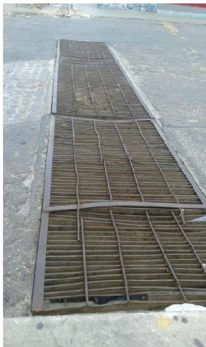
Figura 26: Galeria construída para dar vazão às águas Foto: Franciele Fernandes Data: 29/10/2016
