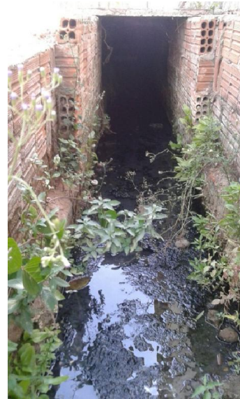
Figura 29: Canalização que cruza a Rua São João (Rua da Lagoa)
