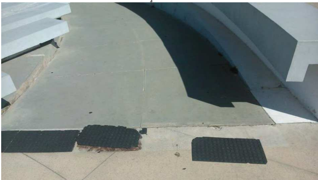
FIGURA 8 – Foto de sinalização tátil deteriorada
