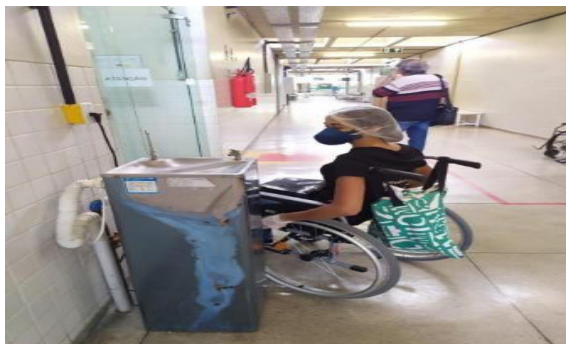
Imagem 1 - Bebedouro não rebaixado
