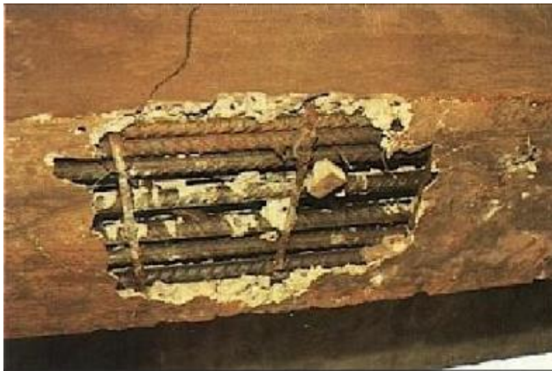
Figura 18: Ninho de concretagem de uma viga, originalmente encoberto por concreto que não penetrou entre a fôrma e as armaduras.
