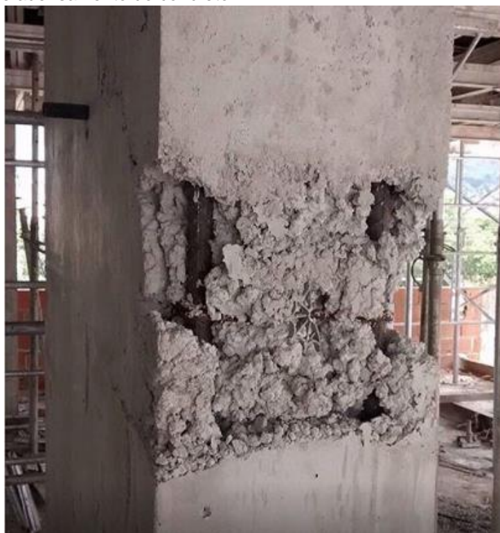
Figura 19: Pilar com ferragens expostas (ninhos de concretagem) após a concretagem devido a falhas no processo de adensamento do concreto.
