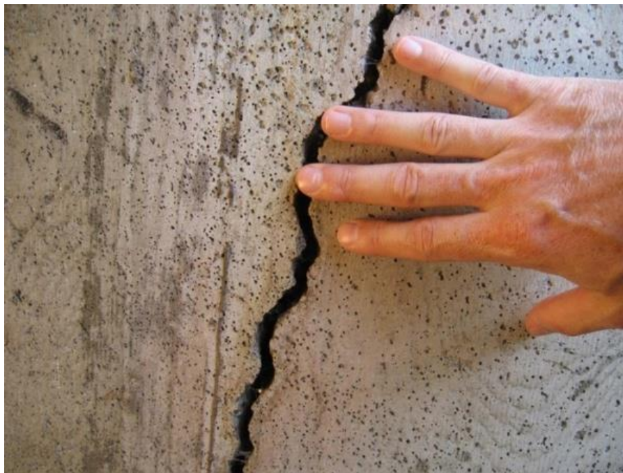
Figura 15: Trinca em estrutura de concreto
