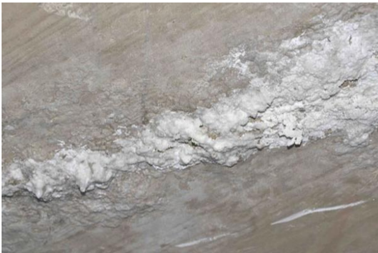
Figura 21: Degradação química no concreto por lixiviação
