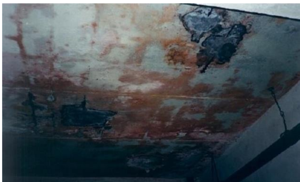
Figura 14: Machas superficiais no concreto devido à corrosão de armaduras por presença de umidade
