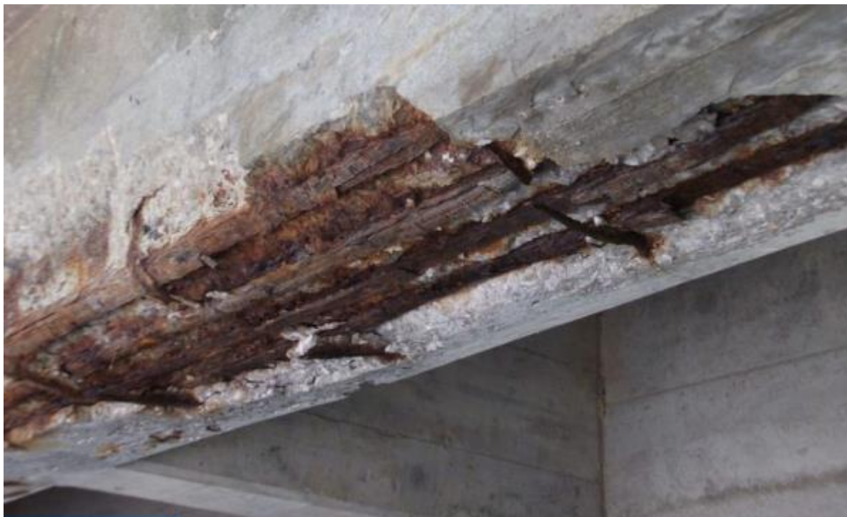
Figura 17: Corrosão na armadura de uma viga
