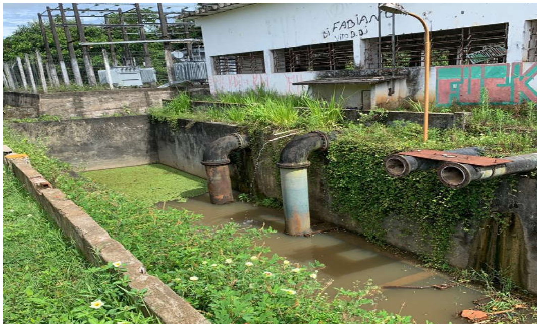
Figura 30 – Poço de sucção da EEAB do rio Mumbaba
