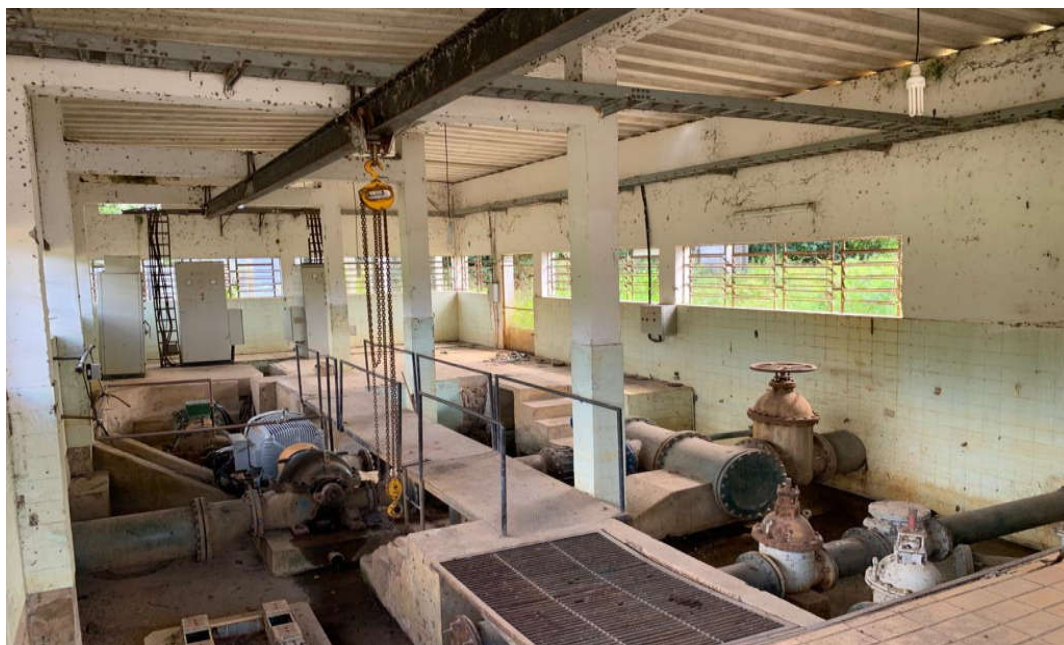
Figura 31 – Casa de bombas da EEAB do rio Mumbaba
