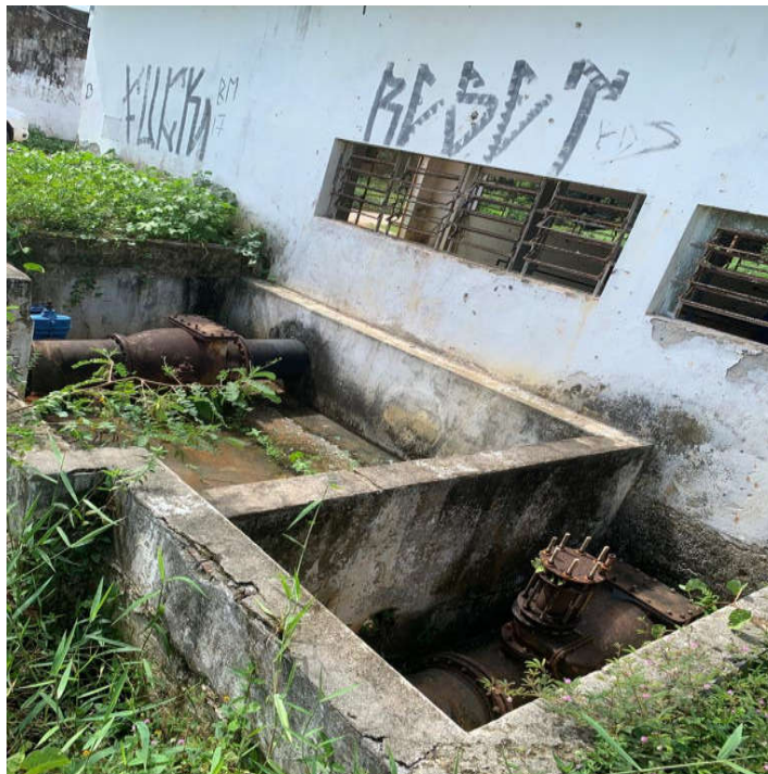
Figura 18 - Saída das duas adutoras da casa de bombas
