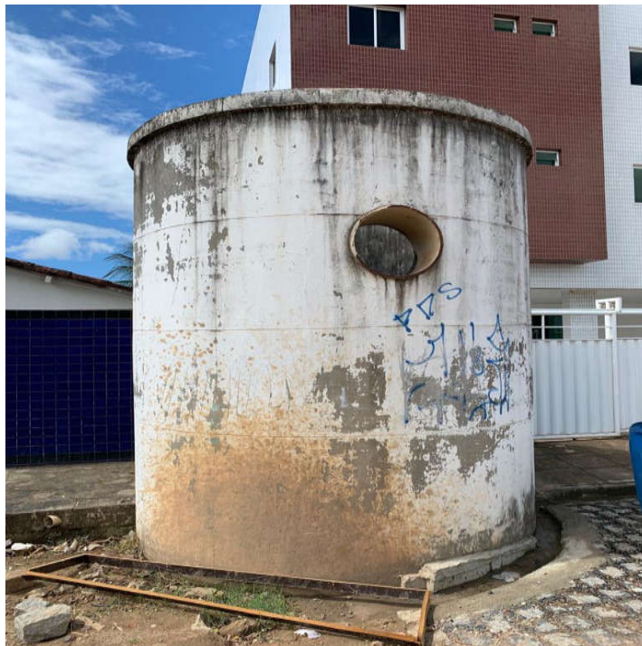
Figura 21 - Reservatório de destino da água recalcada
