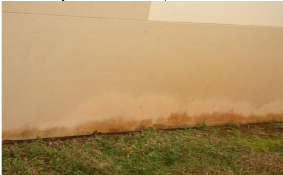
Figura 57 - Mancha de umidade proveniente do solo
