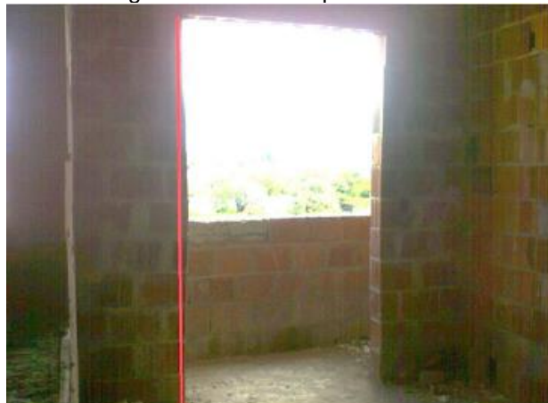
Figura 39 - Falta de prumo
