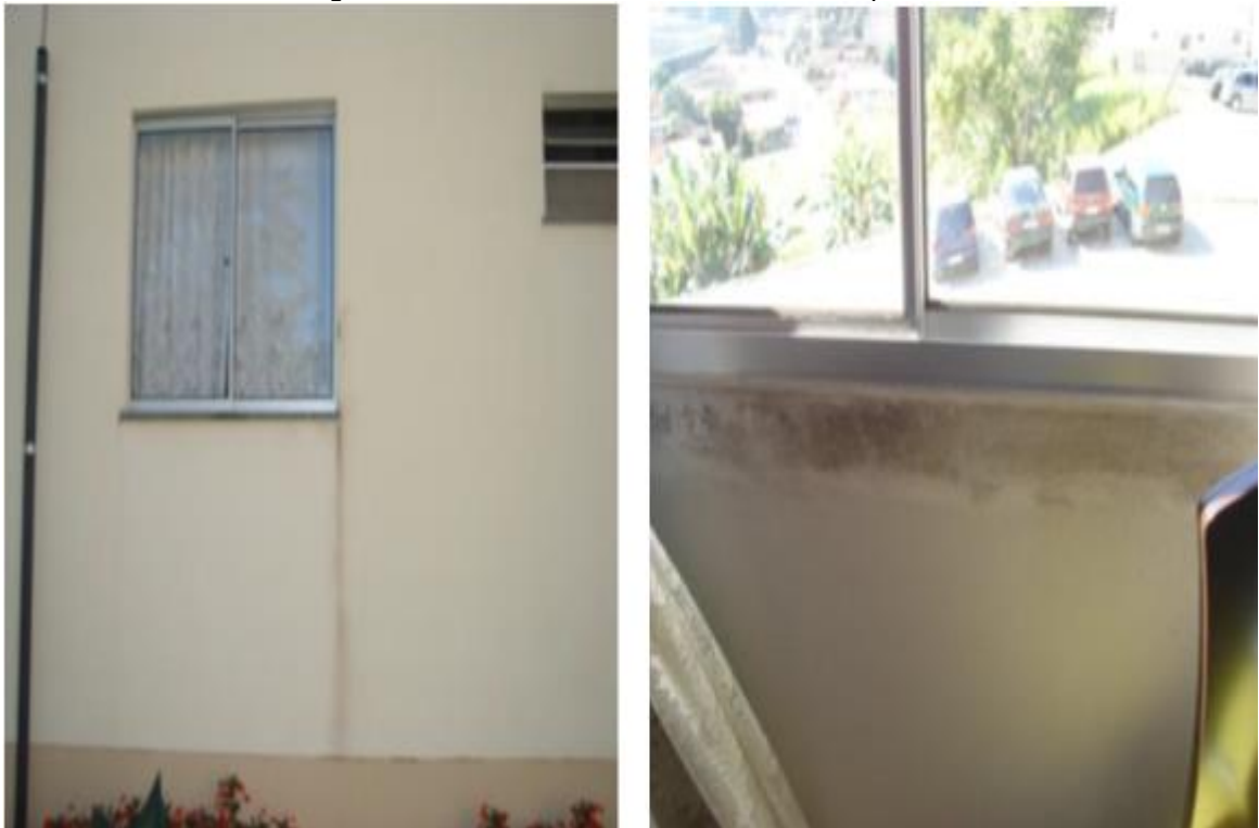
Figura 56 - Manchas de umidade abaixo do peitoril
