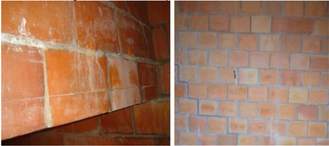
Figura 58 - Eflorescência em parede de alvenaria estrutural
