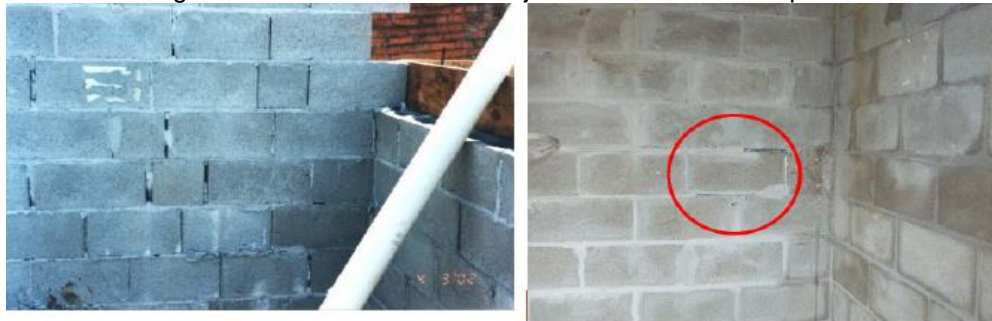
Figura 38 - Preenchimento das juntas de forma inadequada
