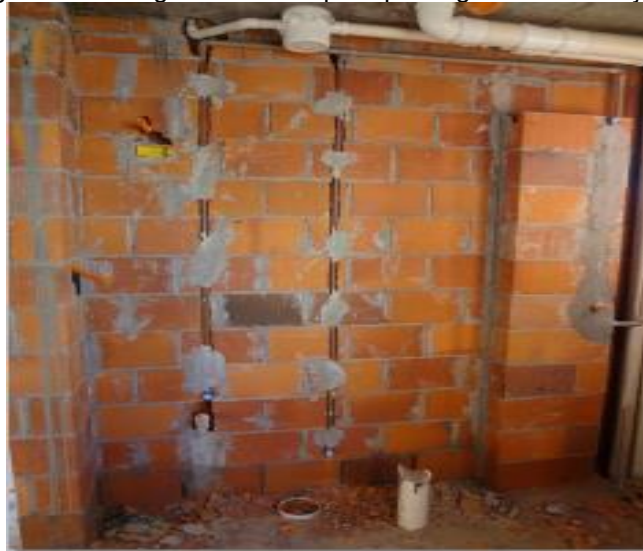
Figura 40 - Rasgos indevidos para passagem de instalações
