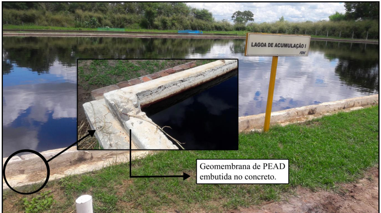
Figura 40 - Lagoa de Acumulação I do chorume na Estação de Tratamento do lixiviado no Aterro Sanitário de João Pessoa/PB.
