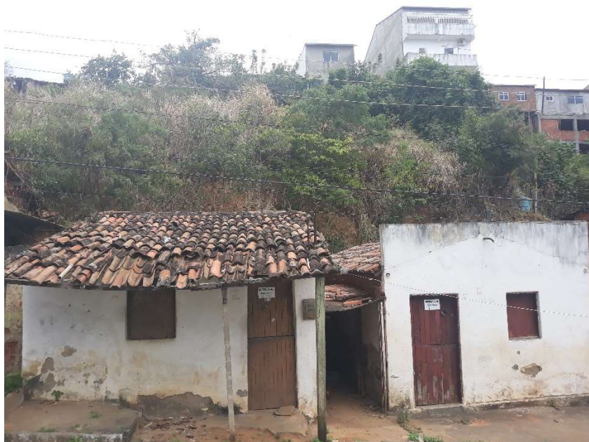
Figura 21 – Casas interditadas pela Defesa Civil. Fonte: Autor
