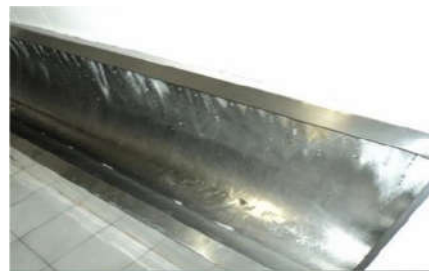
Figura 10 - Mictório coletivo com descarga contínua
