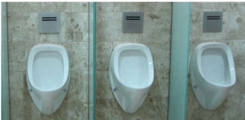
Figura 11 - Conjunto de mictórios com sensor de presença
