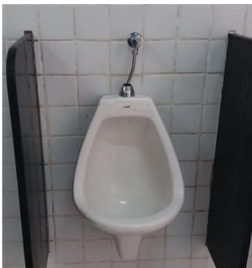
Figura 12 - Mictório com válvula de fechamento automático
