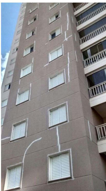
Figura 15 - Tratamento de fachada com trincas
