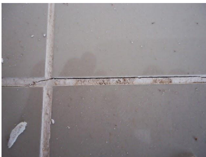
Figura 17 - Deterioração de juntas
