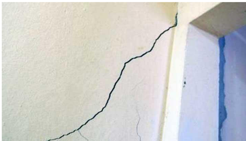
Figura 2 - Fissura: patologia recorrente em alvenarias.
