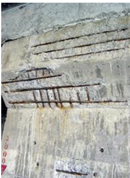
Figura 3 - Desgaste em estrutura de concreto armado.
