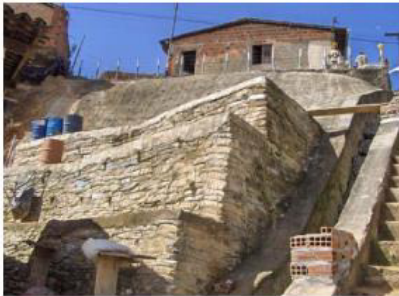
Figura 11. Muro de solo-cimento ensacado no município do Cabo de Santo Agostinho-PE. Fonte: Santana (2006).
