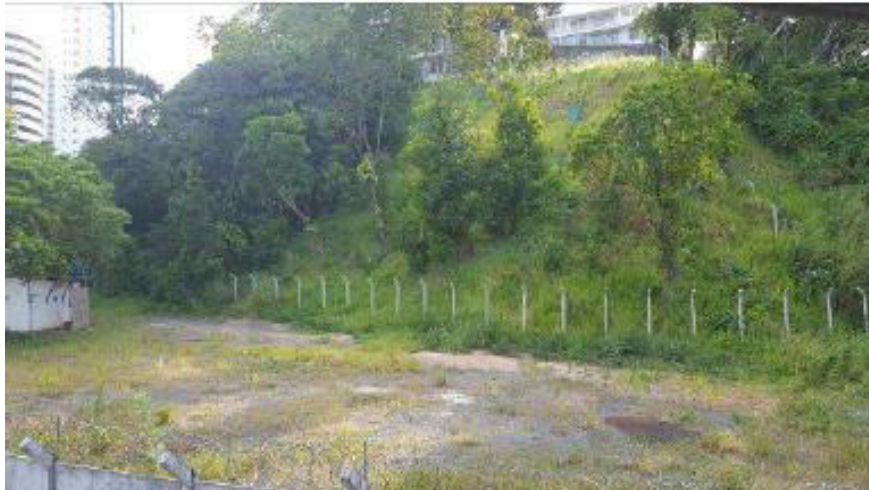
Figura 19. Situação atual do talude. Fonte: Oliveira e Silva (2018)
