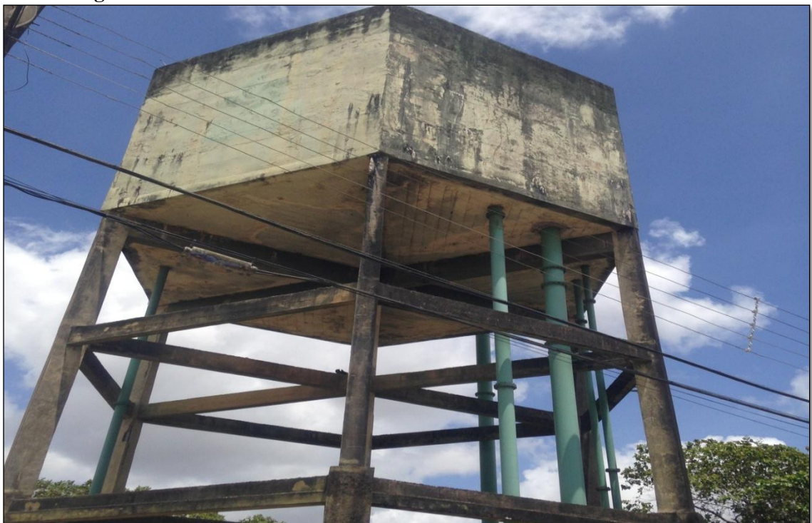
Figura 9 - Reservatório elevado R- 55 localizado no bairro Tibiri II
