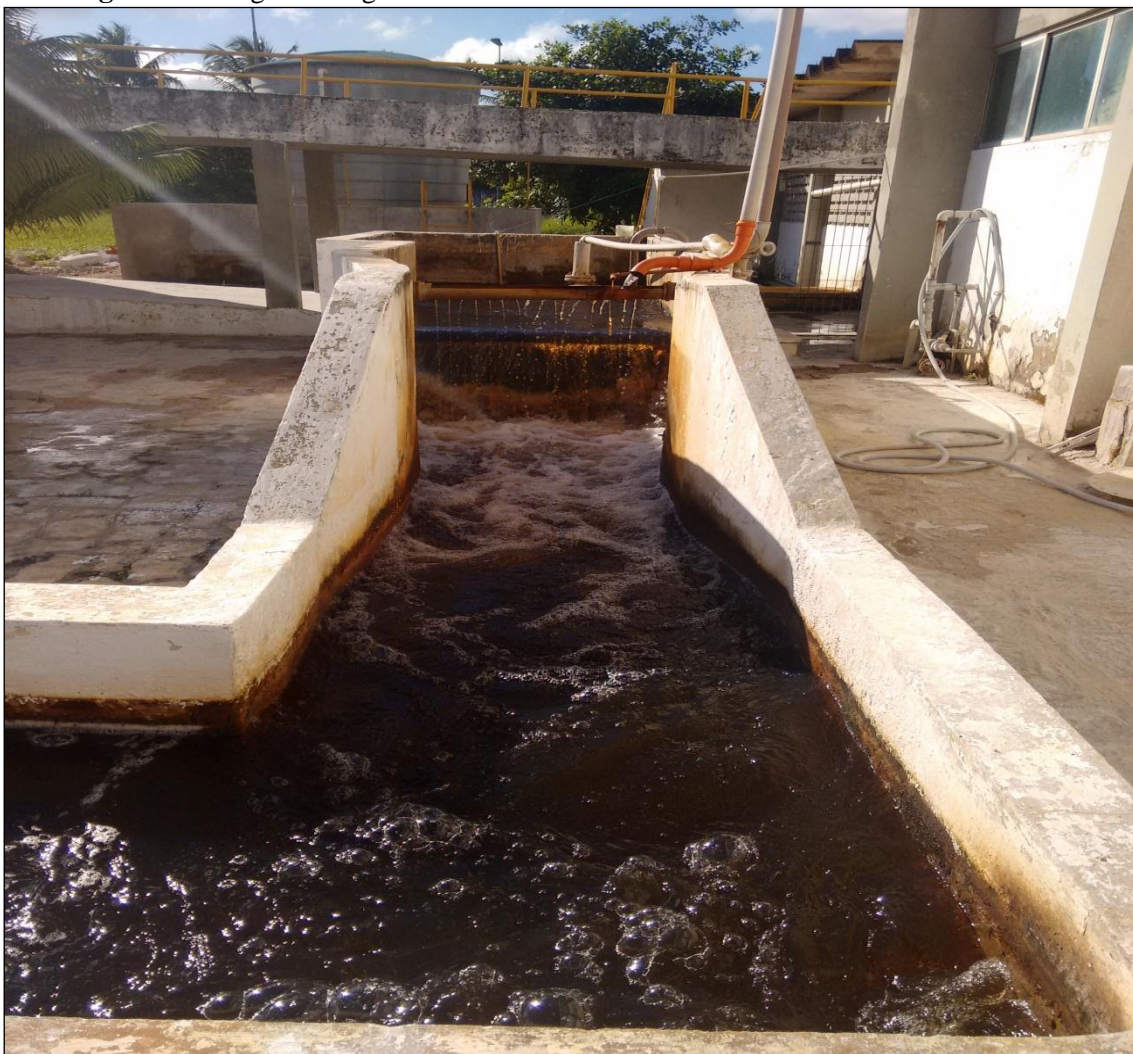
Figura 6 - Chegada da água bruta na calha Paschoal da ETA de Santa Rita
