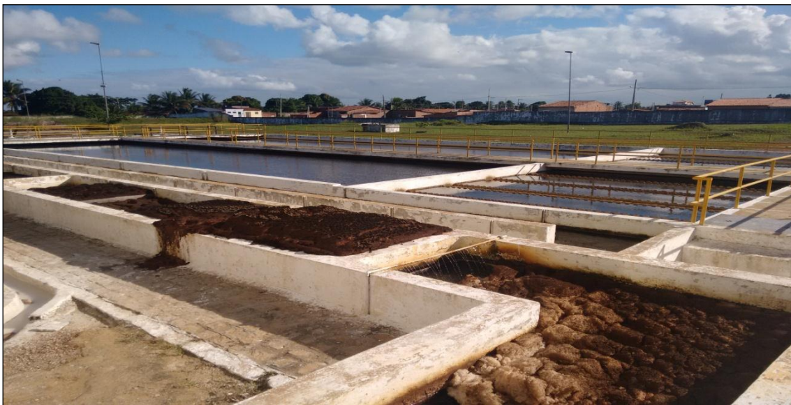
Figura 7 - Floculadores, decantadores e filtros da ETA de Santa Rita
