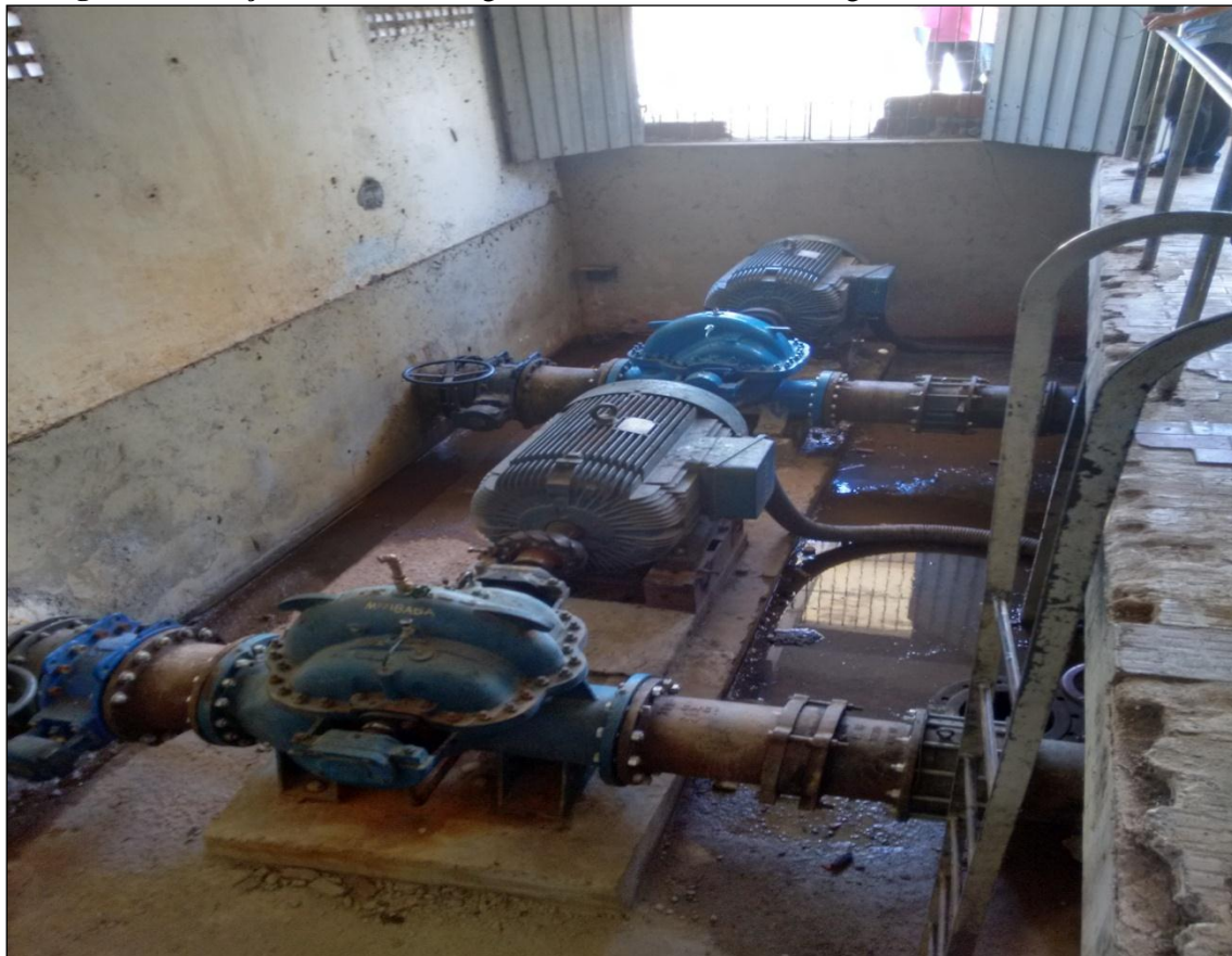
Figura 5 - Estação elevatória de água bruta localizada nas margens do rio Tibiri
