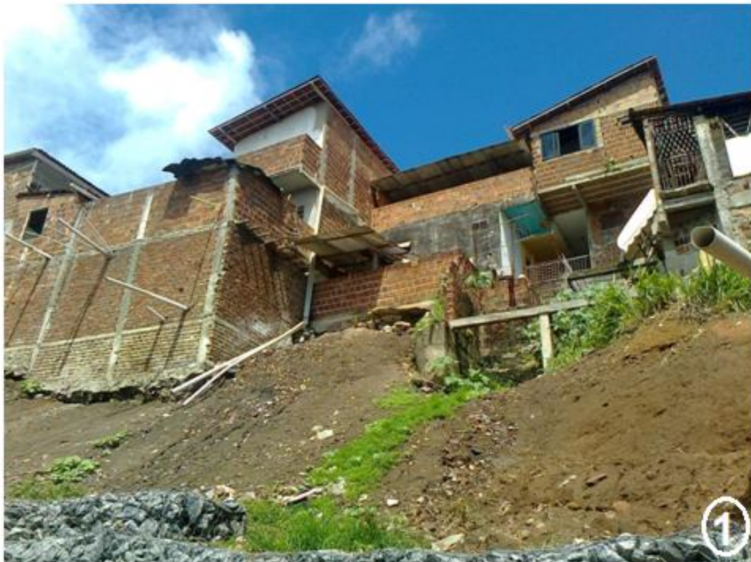
FIGURA 23: Casas no topo do talude e águas servidas expostas diretamente sobre o talude - Comunidade Santa Clara.
