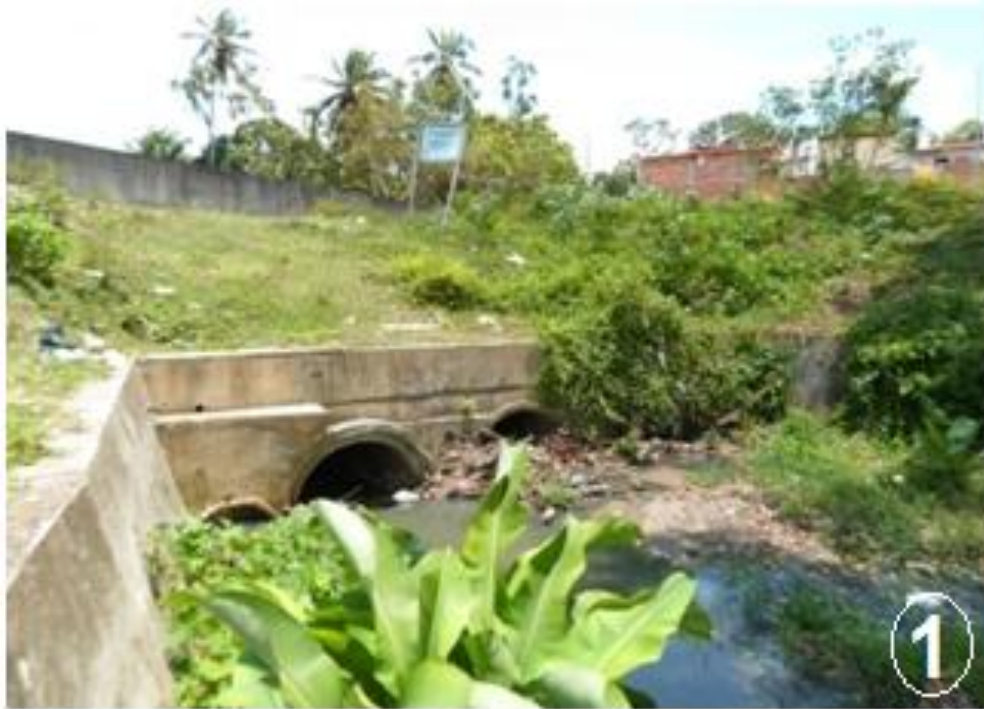
FIGURA 16: Drenagem obstruída no curso do Rio da bomba Av. Boto de Meneses
