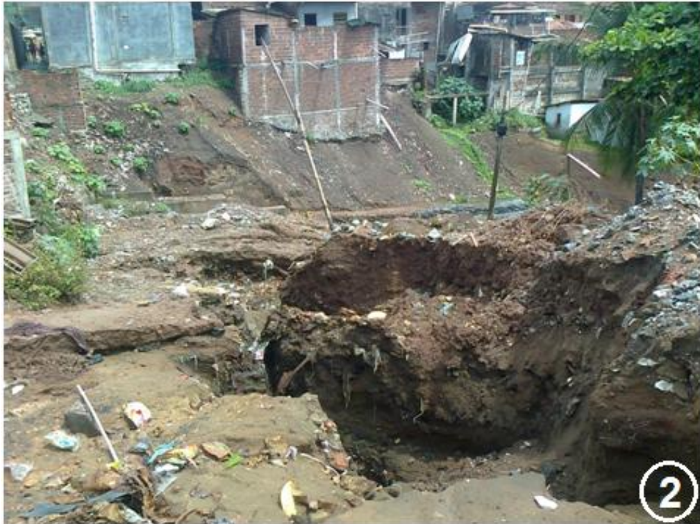
FIGURA 24: Processo erosivo – Comunidade Santa Clara
