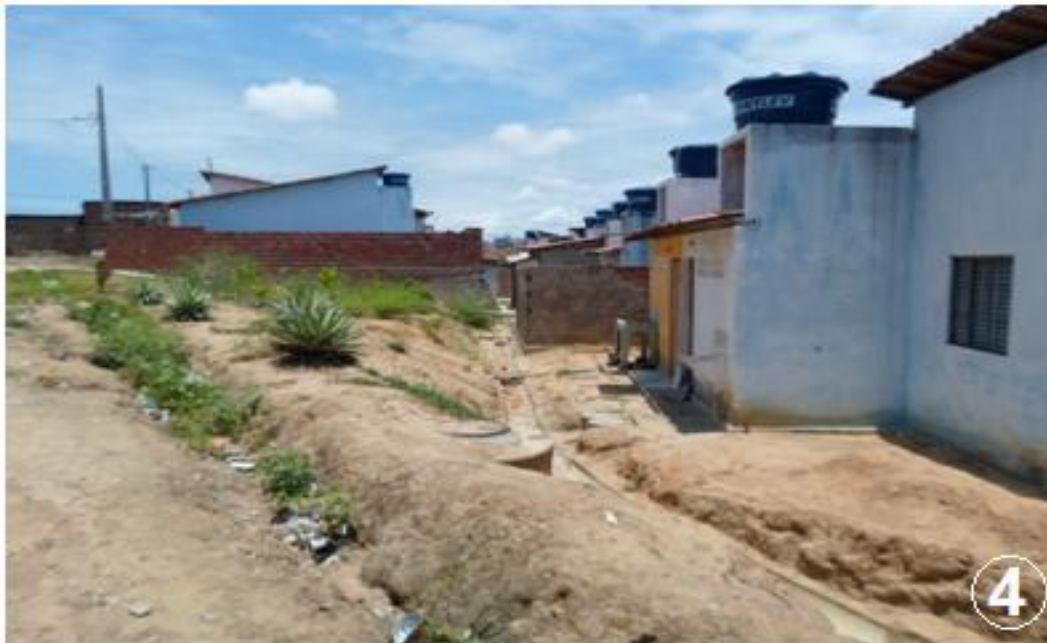
FIGURA 19: Processo erosivo nas vias locais.
