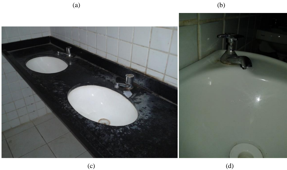
Figura 6- Vazamentos em torneiras do CT: Vazamento no flexível de torneira manual (a), (b) e (c), vazamento em torneira manual através de gotejamento lento (d.) Fonte: Autora.
