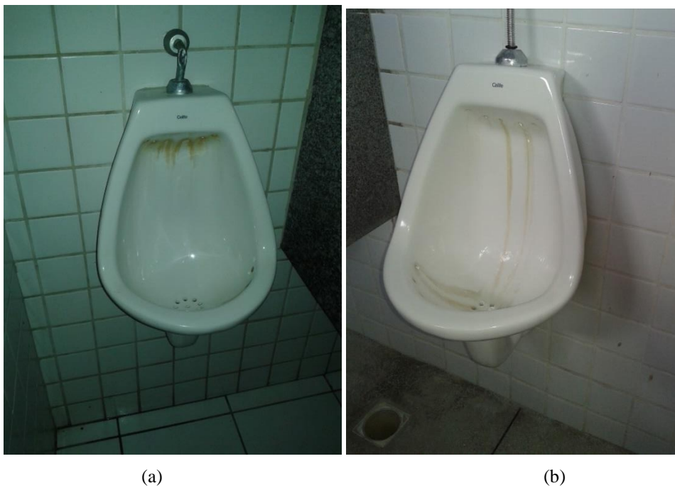
Figura 7- Mictórios com vazamento (a), (b). Fonte: Autora.
