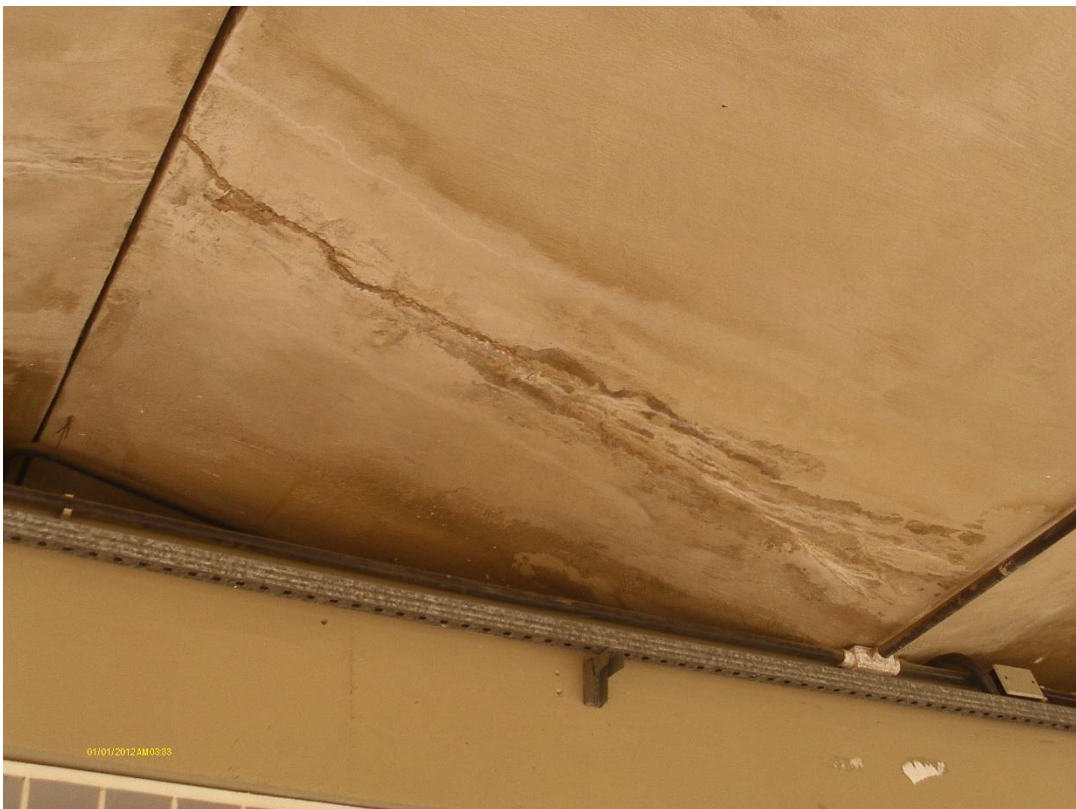
Figura 35 - Formação de Eflorescências
