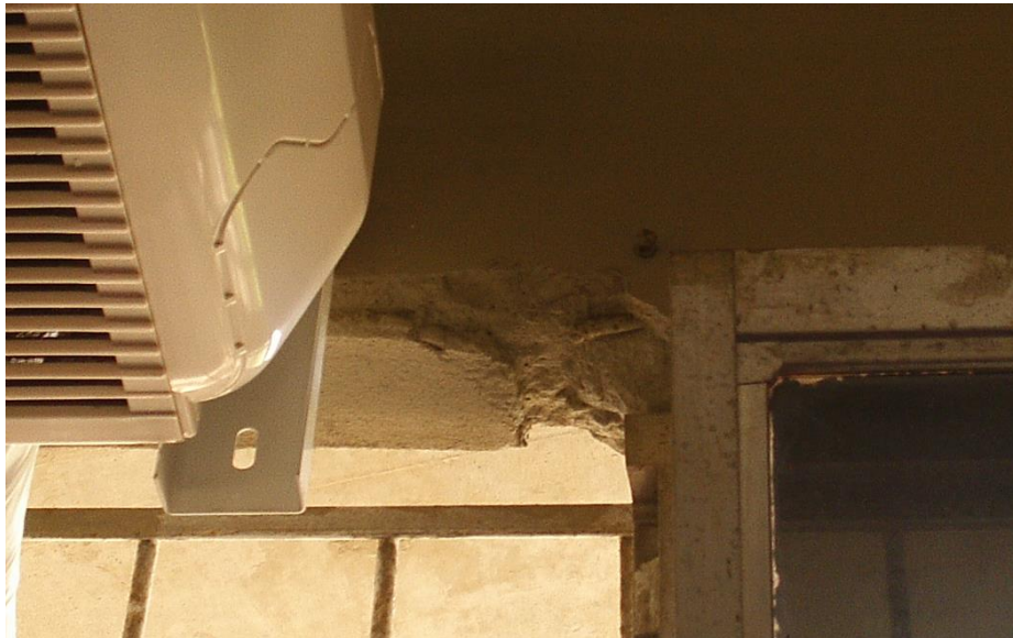
Figura 40 - Detalhe do corte executado na armadura inferior da viga.
