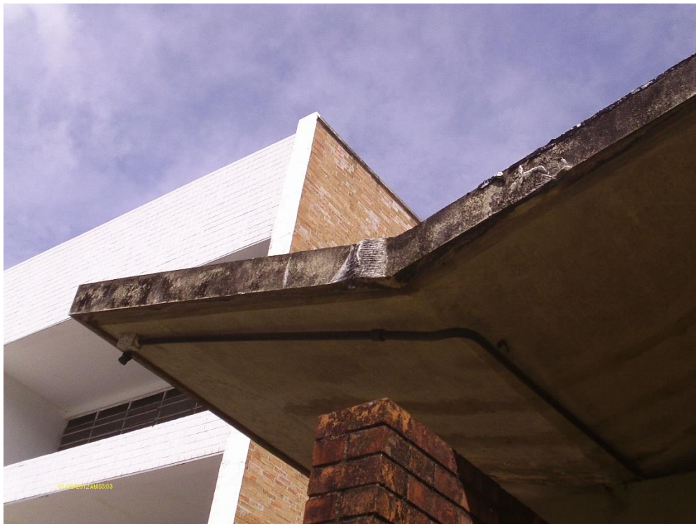
Figura 38 - Formação de Eflorescências na extremidade da pingadeira.
