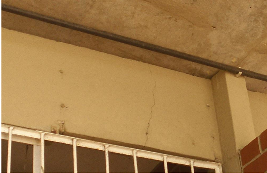
Figura 41 – Fissuras causadas pela subtração da armadura inferior da viga
