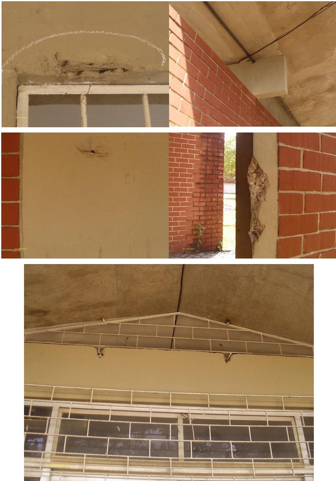
Figura 39 - Patologias encontradas nas vigas e pilares: Armadura exposta devido a colocação de grade; Quebra de viga para passagem de eletroduto; Exposição de armadura causada por perfuração; Exposição da armadura causada por perfuração para fixação de lixeira; Quebra de viga para fixação de grade.
