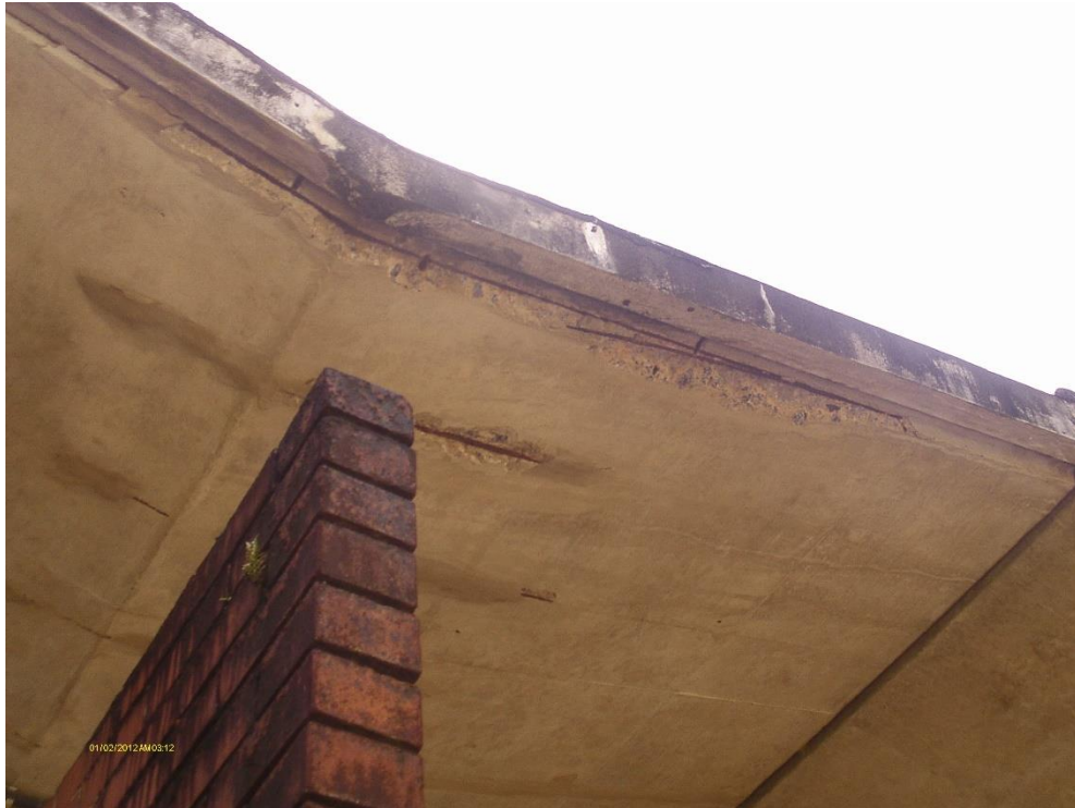
Figura 37 - Corrosão de armaduras na pingadeira. Notar rompimento da armadura.
