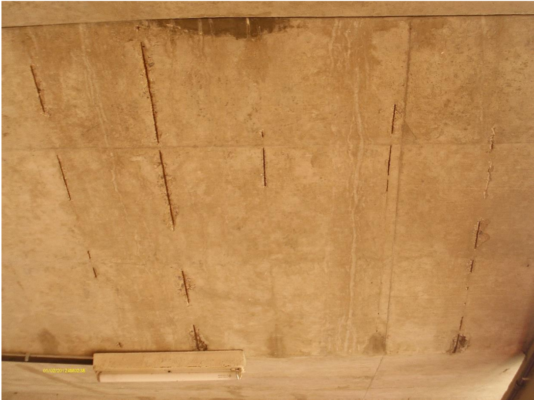
Figura 34 - Corrosão das armaduras causada por falta de recobrimento e exposição a águas pluviais
