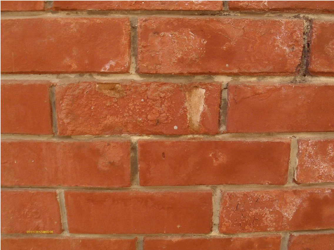
Figura 47 - Destacamento de pintura e desagregação dos blocos.
