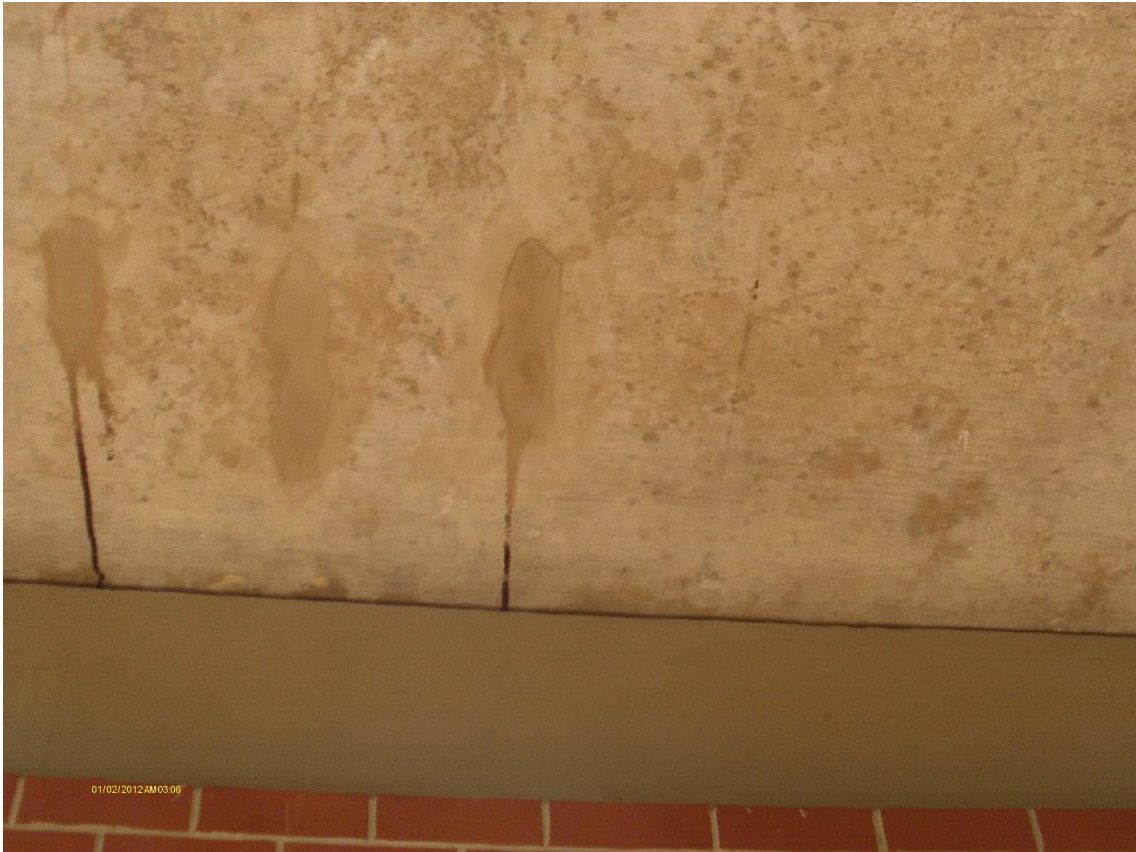
Figura 36 - Destacamento da argamassa aplicada como revestimento. Notar as fissuras no contorno do local de aplicação
