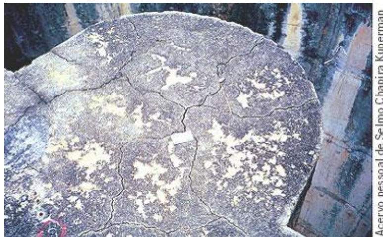
Figura 20 – Reação álcali-agregado em topo de pilar de vertedouro de barragem.
