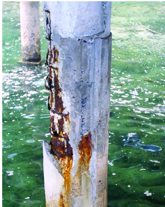
Figura 21 – Corrosão da armadura de estrutura inserida em ambiente marinho devido à ação de cloretos.
