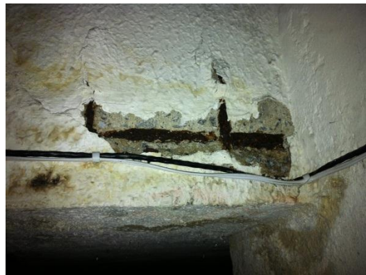
Figura 27 – Armadura longitudinal de viga corroída e deslocamento do concreto carbonatado.
