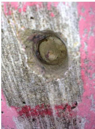
Figura 39 – Furo no pilar 1 com aplicação de fenolftaleína.
