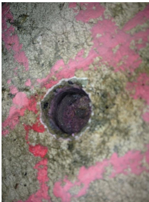
Figura 47 – Indicação da profundidade de carbonatação por meio de fenolftaleína.
