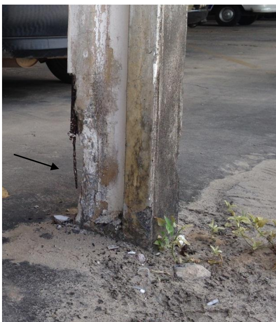
Figura 44 – Deterioração de base de pilar com ruptura de armadura longitudinal - Garagem.
