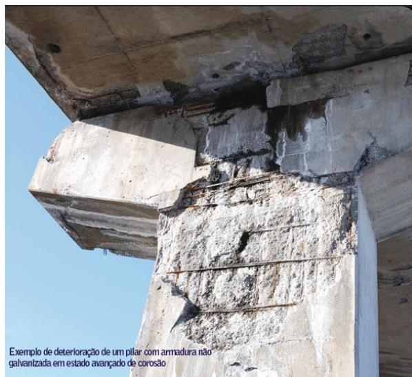
Figura 23 – Topo de pilar com consolo deteriorado por ação de íons sulfatos.
