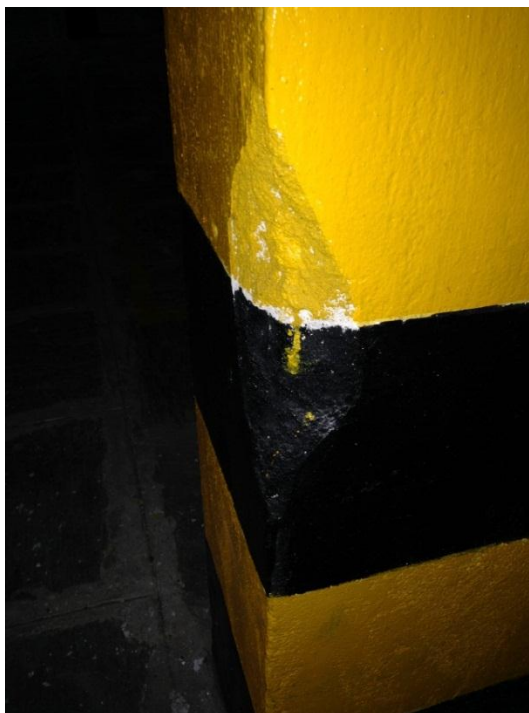
Figura 17 – Desgaste superficial de pilar em virtude de choque com veículo.
