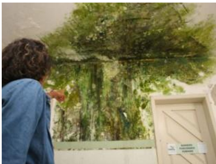
Figura 28 – Presença de fungos em face inferior de laje.
