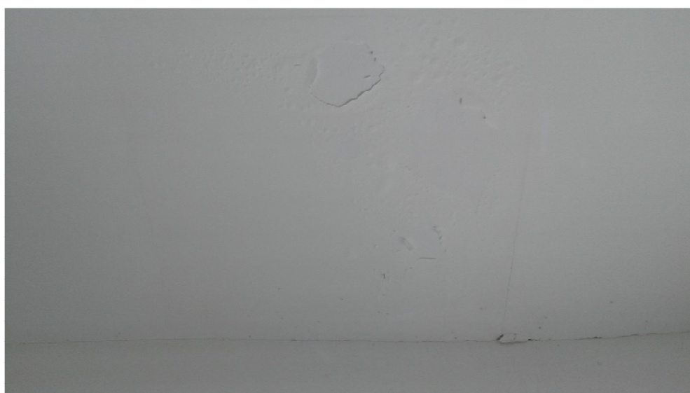
Figura 13 - Infiltração em laje.
