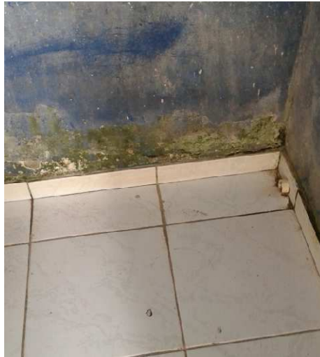
Figura 22 - Manchas de mofo.
