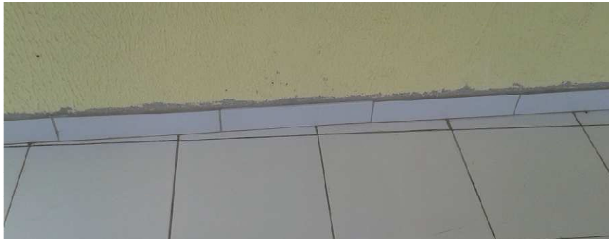
Figura 17 - Alvenaria fora de esquadro.
