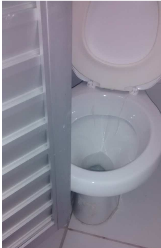
Figura 26 – Porta de banheiro que não abre totalmente por causa de bacia sanitária.
