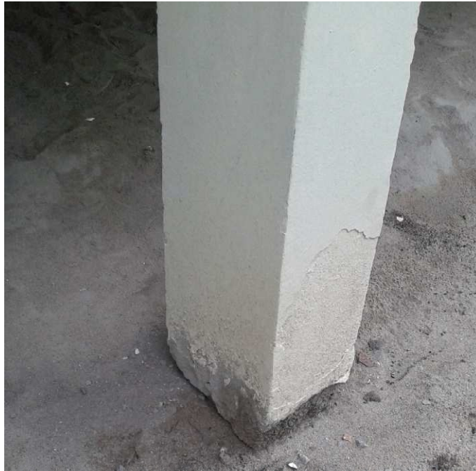
Figura 14 - Infiltração em pilar.
