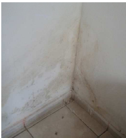
Figura 12 - Manchas acima do rodapé.
