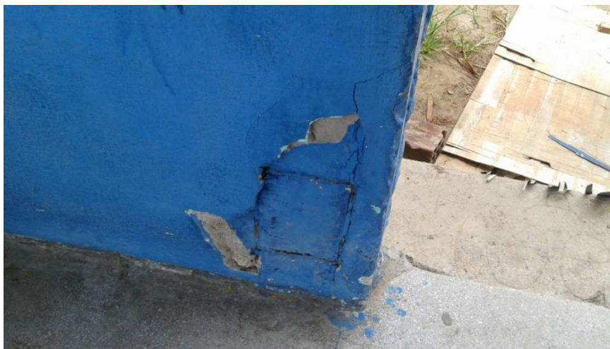
Figura 15 - Armadura exposta em pilar.
