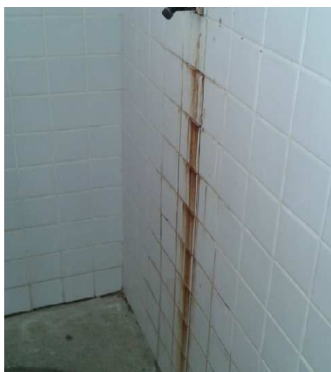
Figura 25 – Torneira com vazamento.
