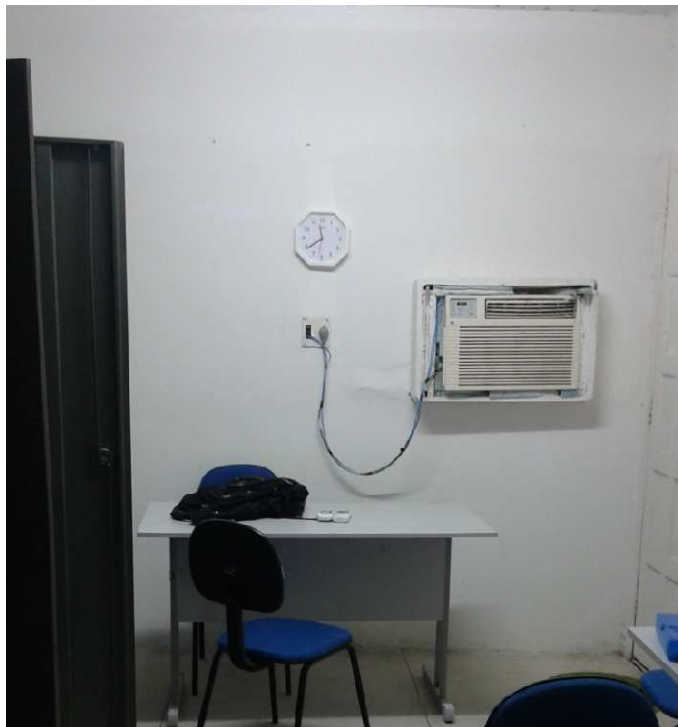
Figura 24 - Ponto de tomada e de disjuntor fora dos padrões.
