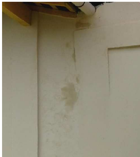
Figura 21 - Infiltração causada por falta de manutenção do telhado.
