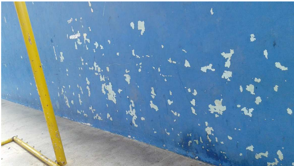
Figura 23 – Descascamento de pintura.
