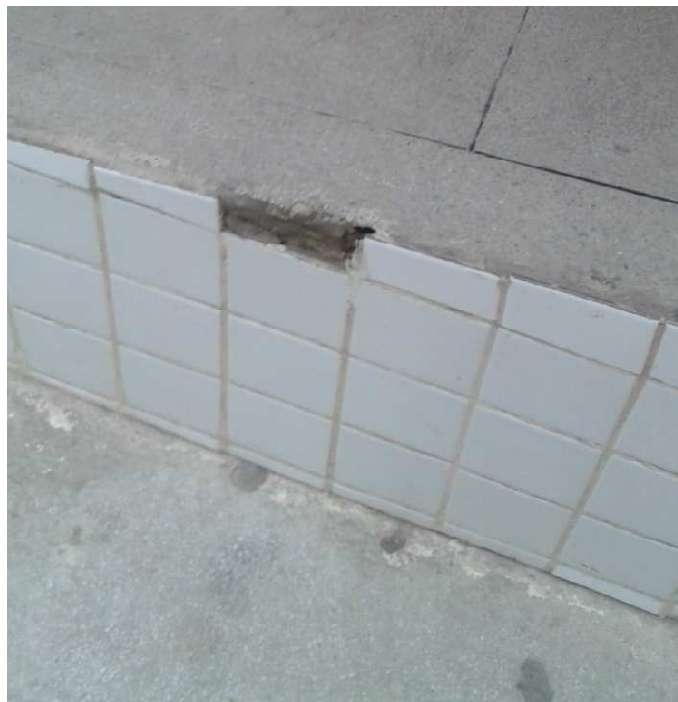
Figura 20 - Desplacamento de revestimento.
