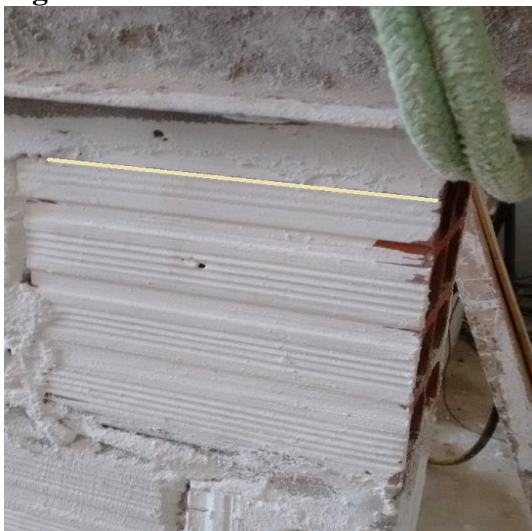
Figura 19 – Primeira fissura verificada
