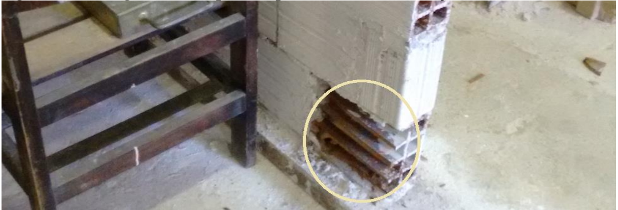
Figura 28 – Esmagamento completo da primeira fiada e fissuração na última
