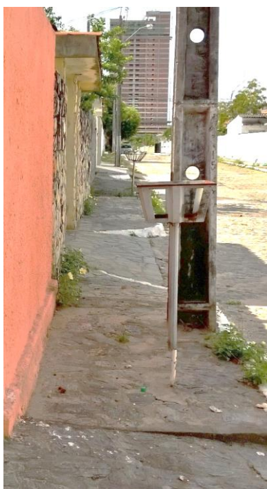
Figura 47 - Calçadas com falta de continuidade e mobiliário urbano interrompendo a passagem – Av. Ceará, Bairro dos Estados
