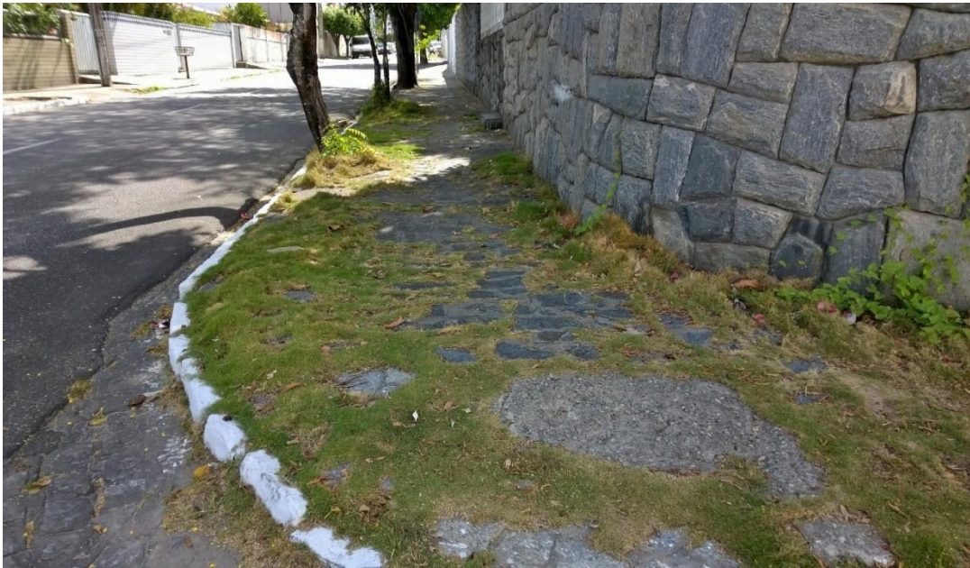
Figura 34 - Calçada sem manutenção na avenida Espírito Santo - Bairro dos Estados
