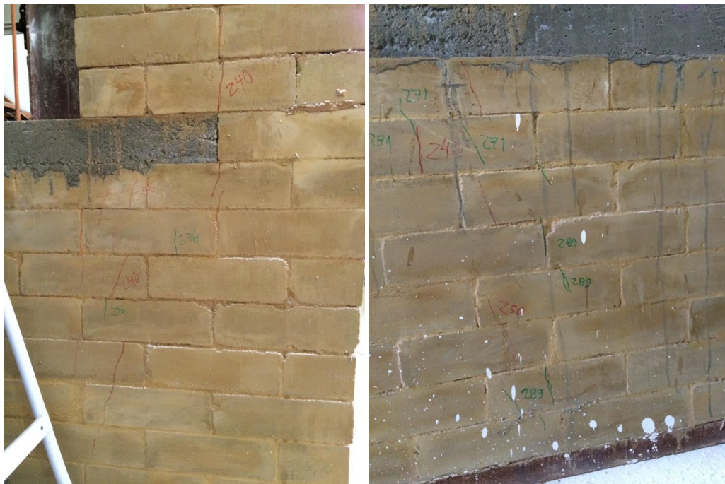
Figura 32. Fissuras observadas na Parede 1, região abaixo da contra-verga, nas faces frontal e posterior, respectivamente.
