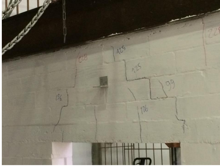
Figura 42. Fissuras de cisalhamento na Parede 3.
