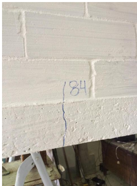
Figura 41. Primeira fissura na Parede 3.
