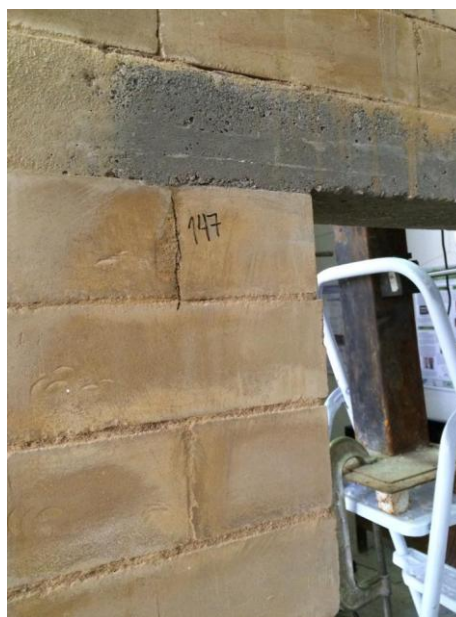
Figura 31. Primeira fissura observada na Parede 1, na face posterior.
