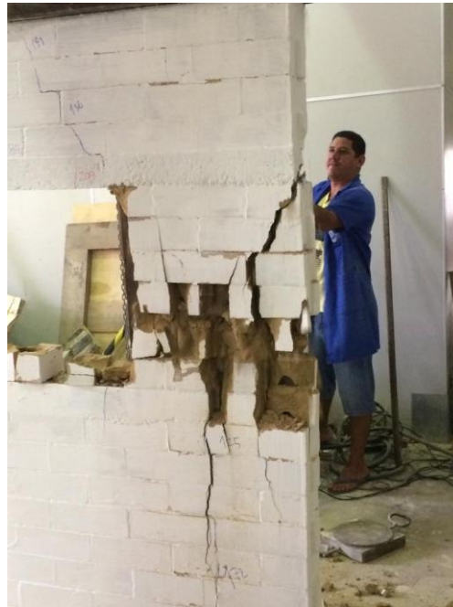
Figura 43. Ruptura da Parede 3.
