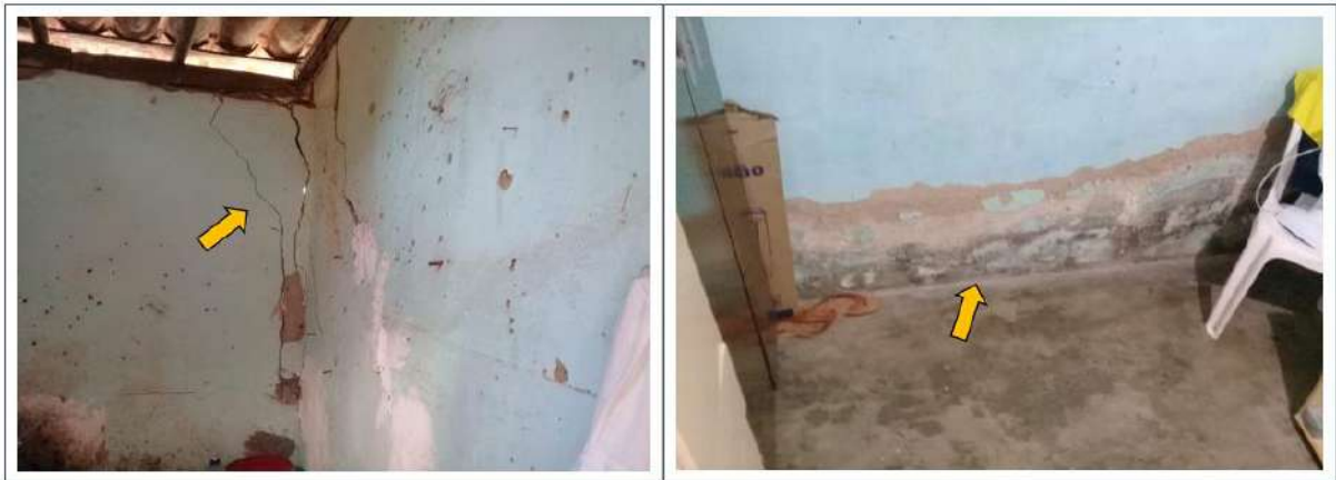
Figura 30 - Imóvel interditado pela Defesa Civil de João Pessoa (Relatório 08).
