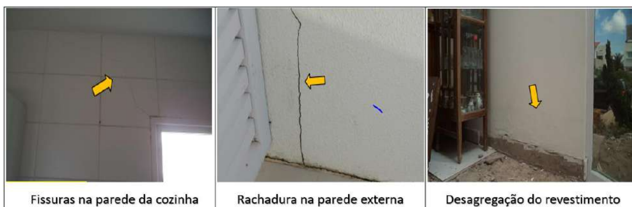
Figura 16 - Manifestações patológicas na residência unifamiliar (Relatório 27).
