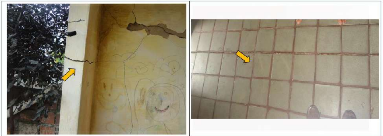
Figura 25 - Manifestações patológicas devido ao recalque por acomodação do solo.
