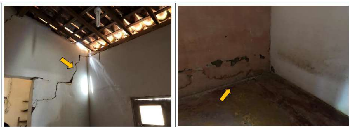
Figura 24 - Manifestações patológicas devido ao recalque por capilaridade excessiva.
