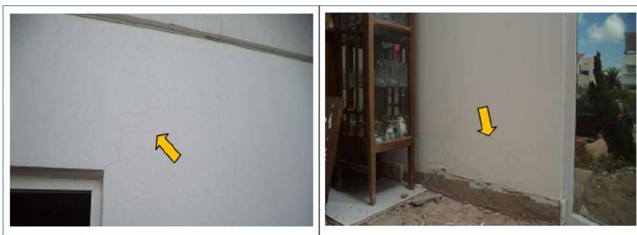
Figura 29 - Manifestações patológicas necessitadas de reparos urgentes (Relatório 27).
