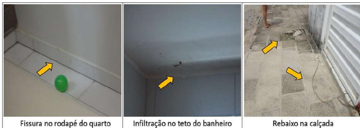
Figura 15 - Manifestações patológicas no edifício residencial multifamiliar (Relatório 7).
