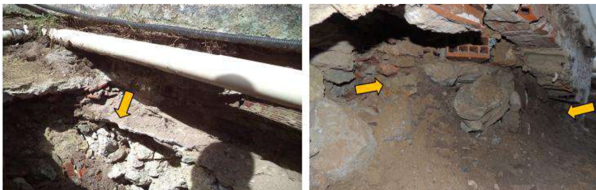
Figura 17 - Fundações com vícios construtivos (pedra não argamassada).
