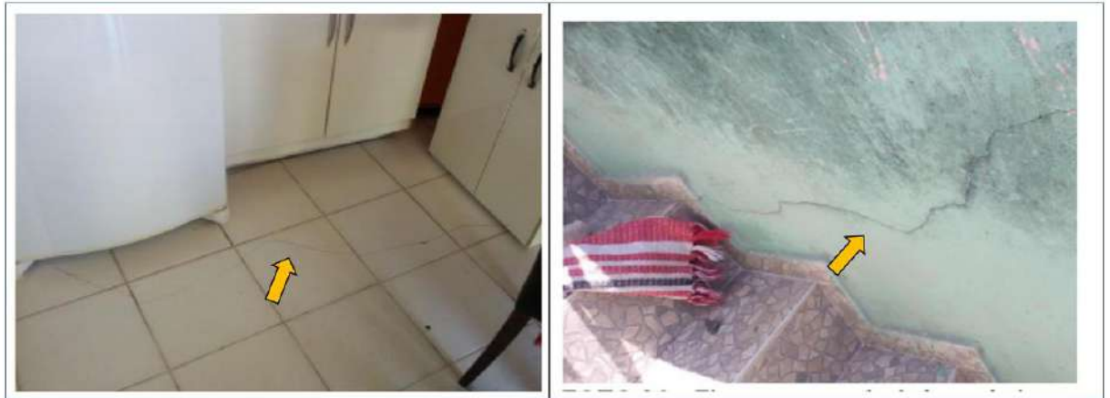
Figura 26 - Manifestação patológica devido ao recalque diferencial por adensamento do solo.
