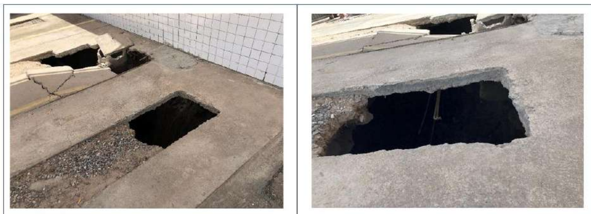
Figura 28 - Manifestações patológicas necessitadas de reparos simples (Relatório 05).
