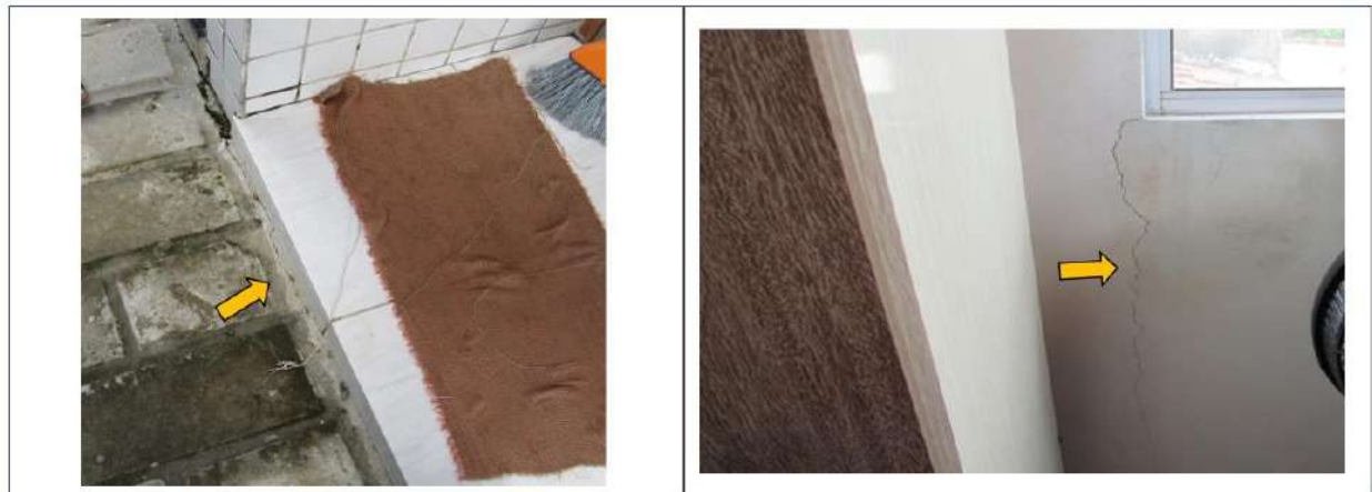
Figura 27 - Manifestação patológica devido ao recalque diferencial por falta de compactação do solo.
