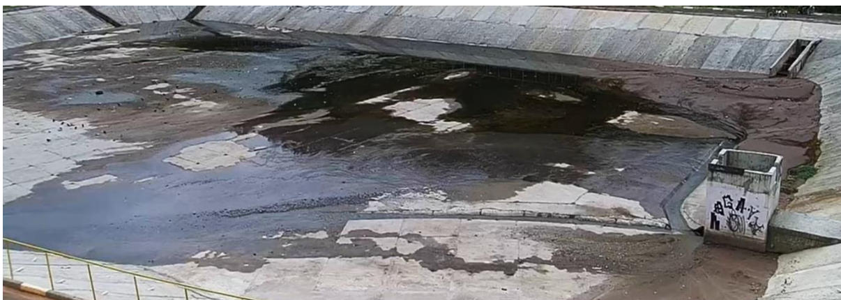
Figura 17 - Resíduos acumulados em um reservatório de detenção na cidade de Embu das Artes, no estado de São Paulo.
