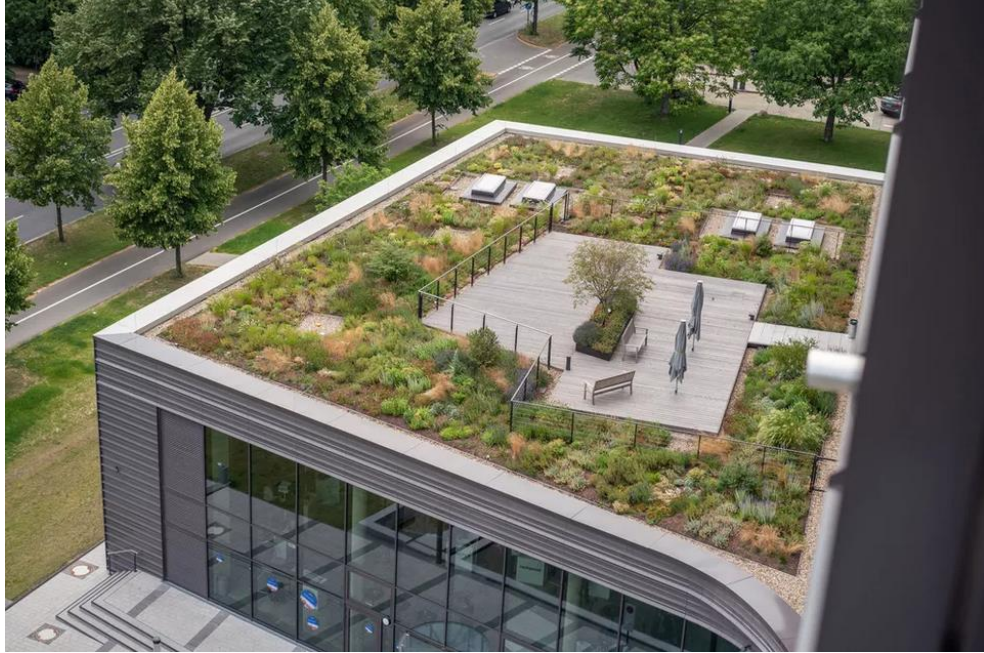
Figura 31 - Telhado verde implantado sobre prédio da Escola de Finanças e Administração de Frankfurt.
