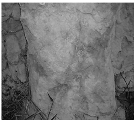
Figura 18 – Desagregação em pilar
