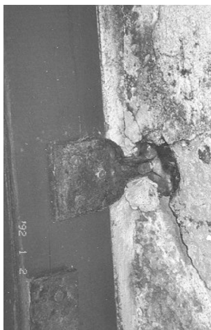
Figura 10 – Expansão de produtos de corrosão
