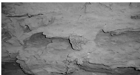
Figura 21 – Esfoliação em base de pilar
