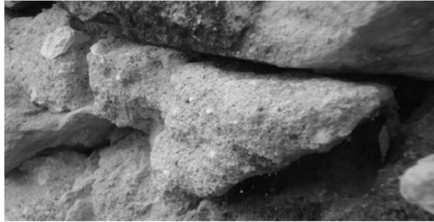
Figura 27 – Perda do rejunte
