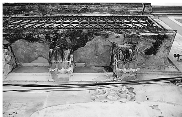
Figura 19 – Desagregação em varanda
