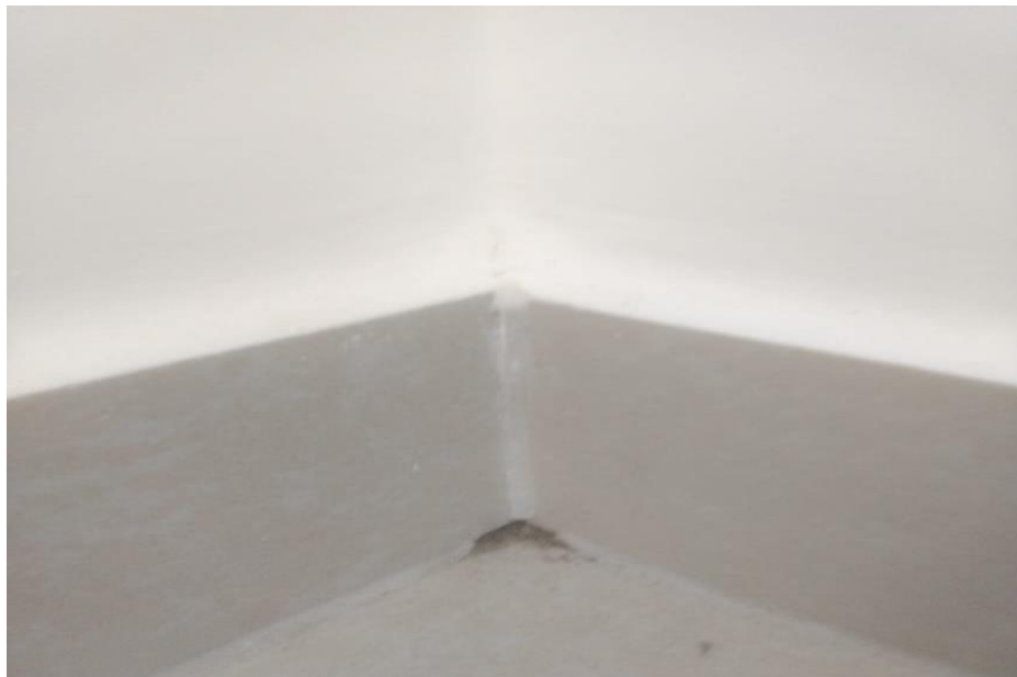
Figura 12 - Patologia aparente observada no rejunte do rodapé da Suite Master
