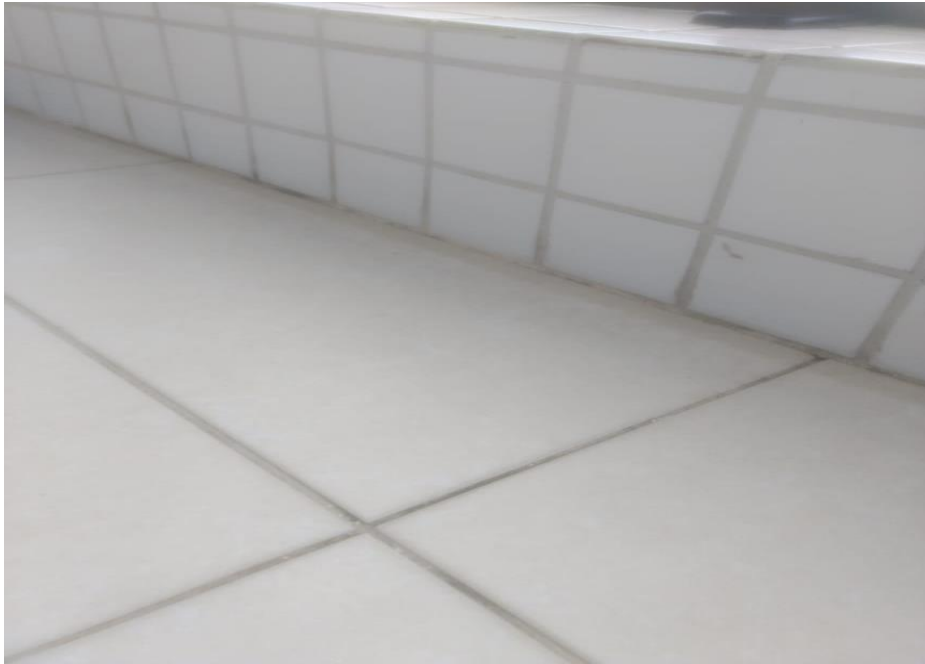
Figura 13 - Patologia aparente observada no rejunte do piso da Varanda Gourmet
