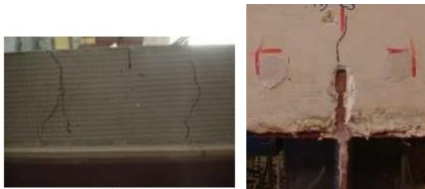
Figura 34 - Região fissurada na laje de concreto
