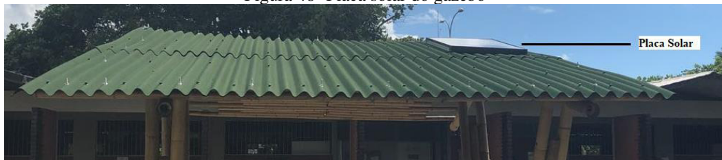
Figura 48- Placa solar do gazebo
