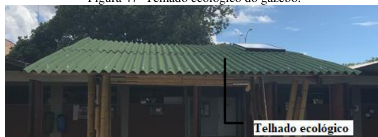
Figura 47- Telhado ecológico do gazebo.
