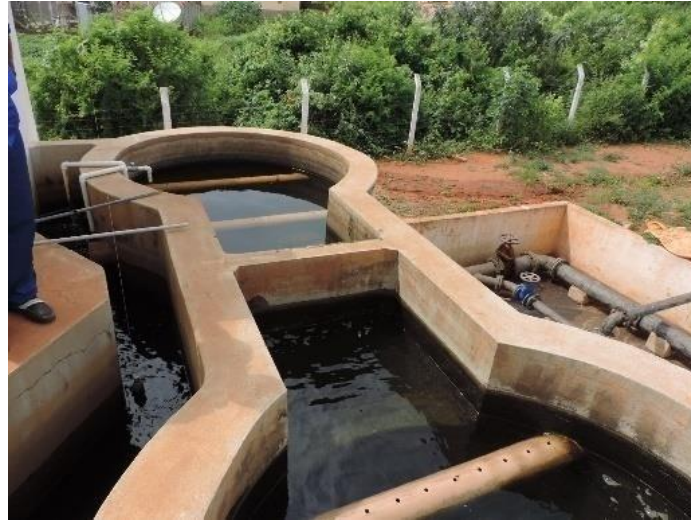
Figura 11 – Filtros russos da ETA do município de Manaíra
