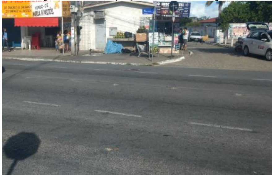
Figura 20: Pintura de separação de sentidos da via desgastada
