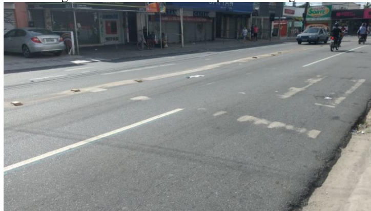
Figura 21: Pintura da faixa de pedestres desgastada
