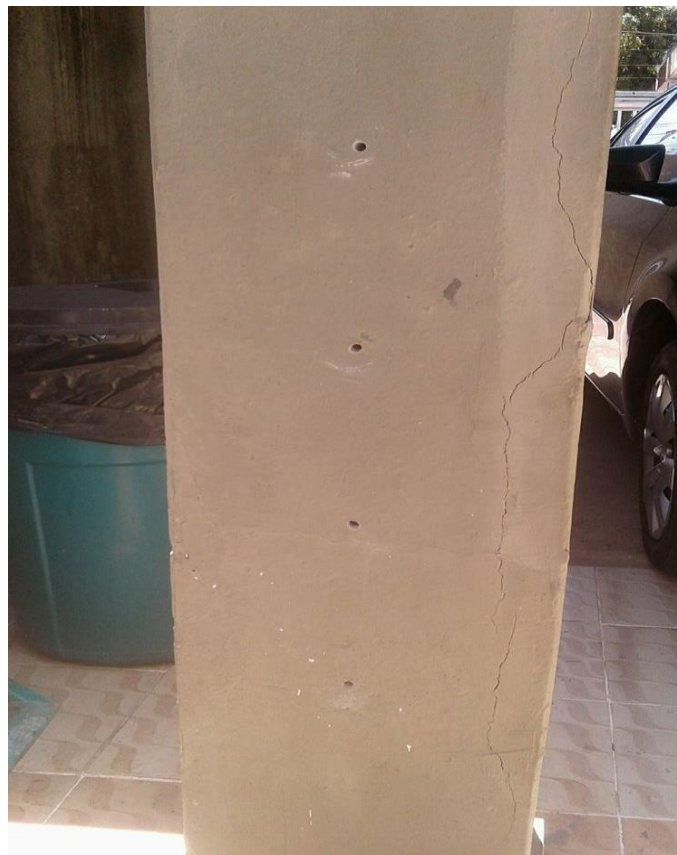
Figura 32 - Perfurações e fissuras no pilar.
