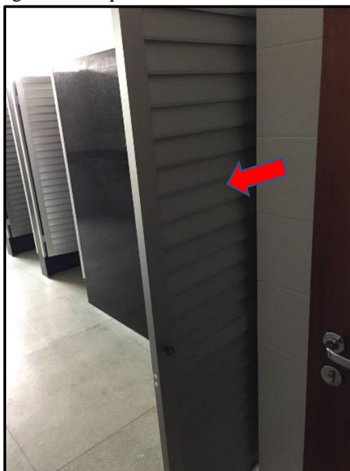
Figura 20: Esquadria do banheiro com defeito
