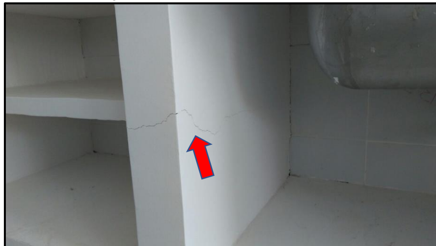
Figura 15: Fissuras na alvenaria do balcão
