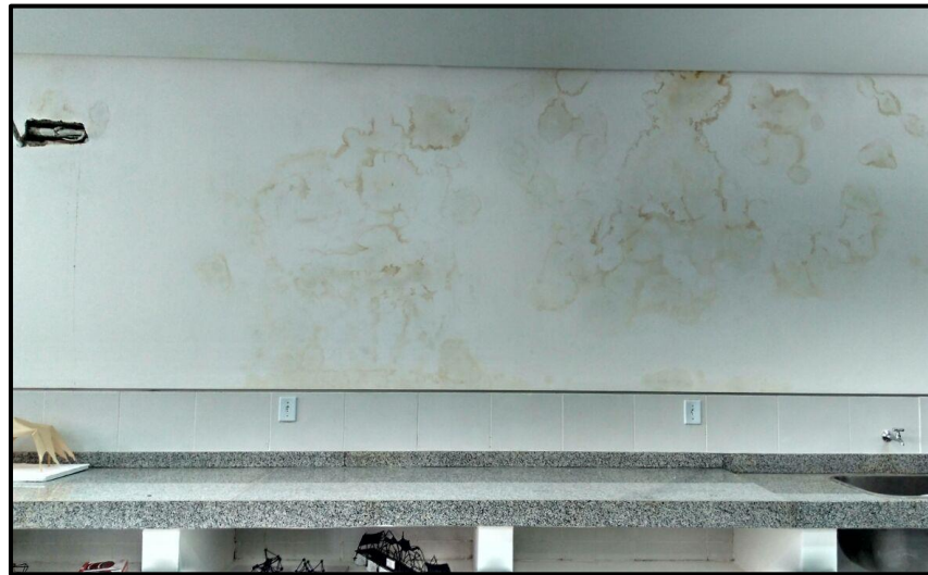
Figura 17: Manchas no revestimento interno
