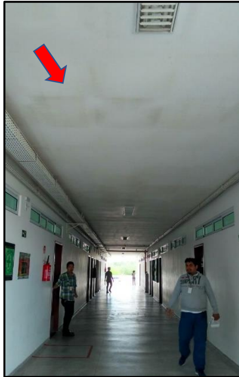
Figura 18: Manchas no gesso
