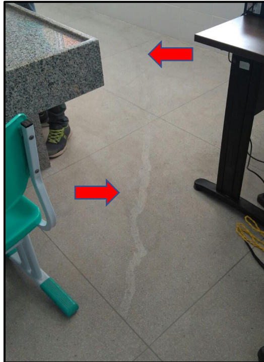
Figura 21: Fissuras no piso granilite
