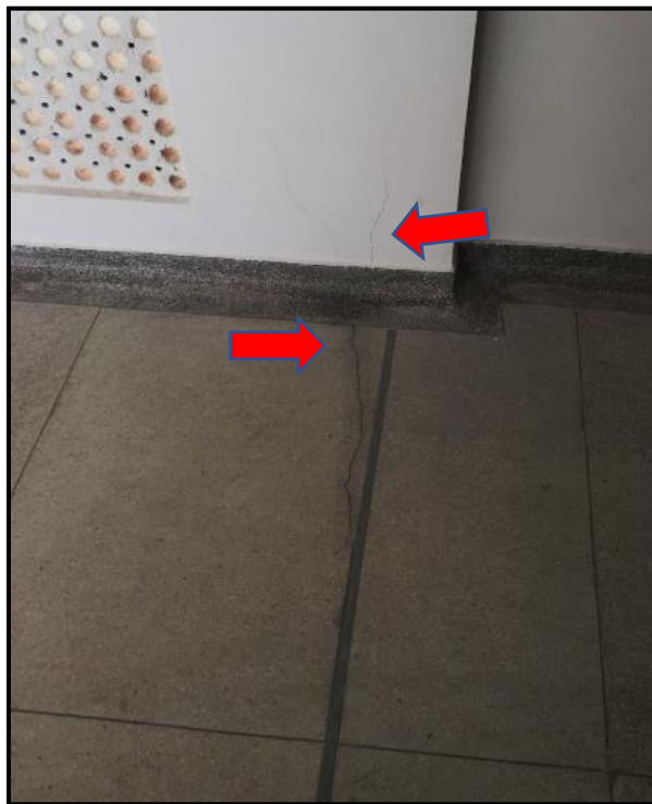
Figura 10: Fissuras próximas a junta de dilatação
