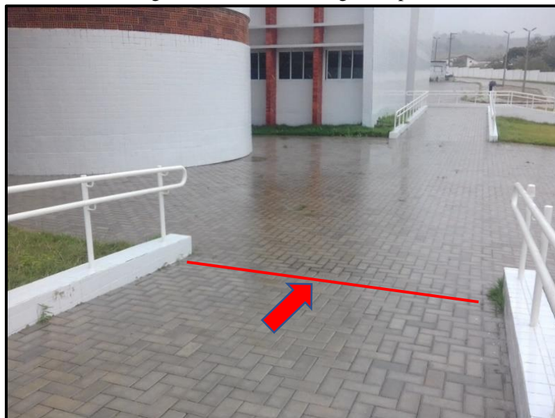
Figura 22: Acúmulo de água no piso
