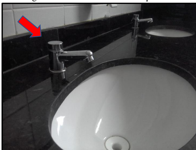
Figura 26: Torneira do banheiro quebrada
