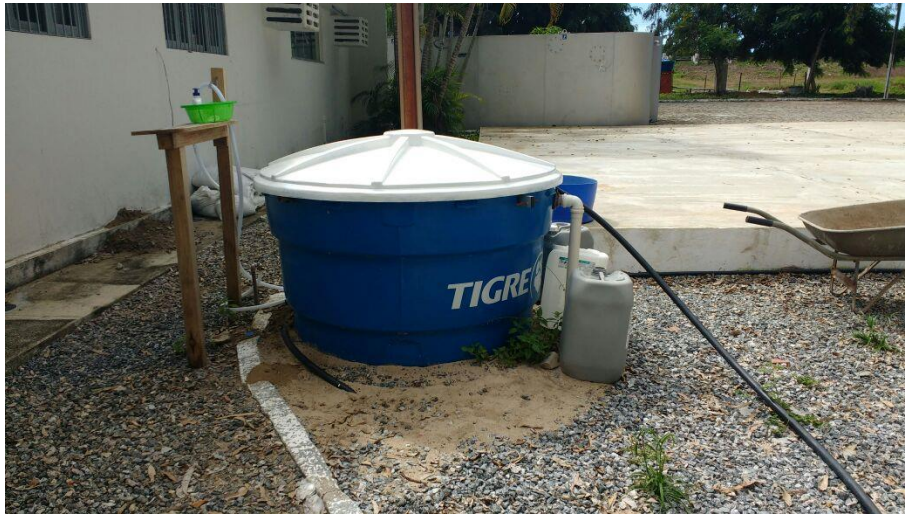
Figura 16 - Tanque de armazenamento de esgoto da lagoa de filtração
