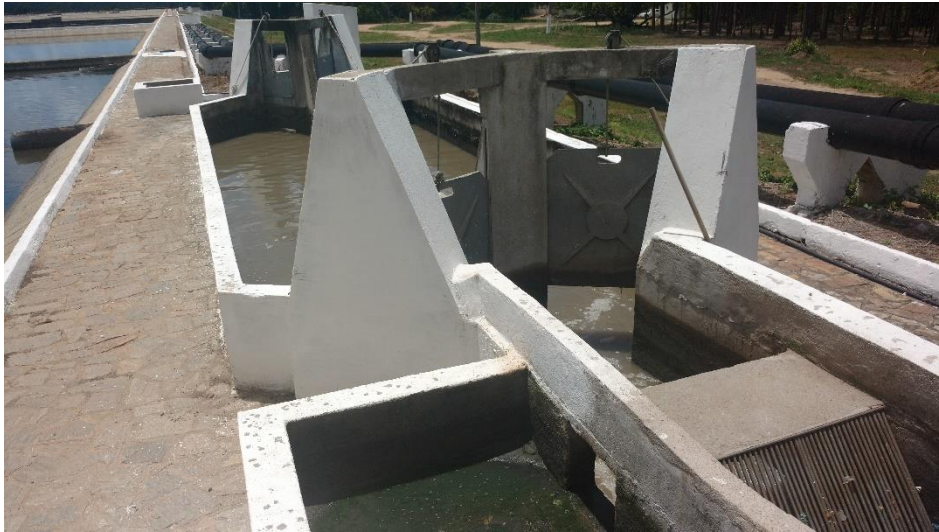
Figura 14 - Vista do tratamento preliminar
