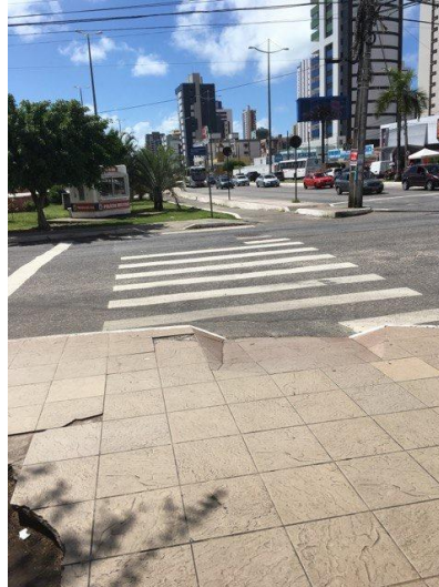
Figura 12 - Falta de sinalização em rampas de deficiente no Bairro Manaíra
