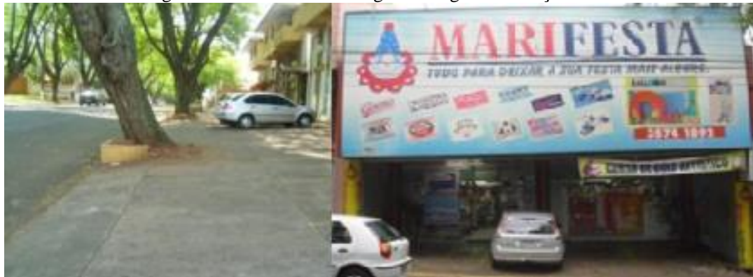
Figura 4 - Rebaixamento irregular das guias da calçada
