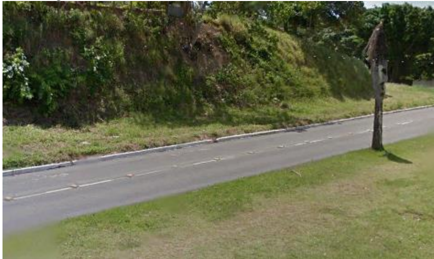
Figura 9 - Ausência de calçamento na Av. Ministro José Américo
