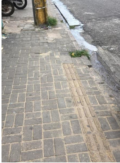
Figura 20 - Piso tátil sem continuidade
