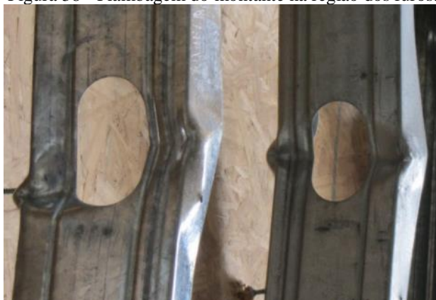
Figura 38 - Flambagem do montante na região dos furos.
